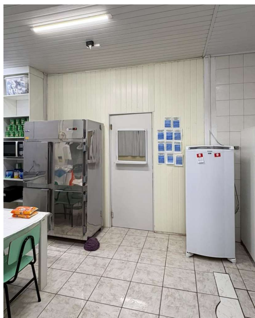
Imagem 2 – Parede de PVC existente na cozinha a ser substituída
