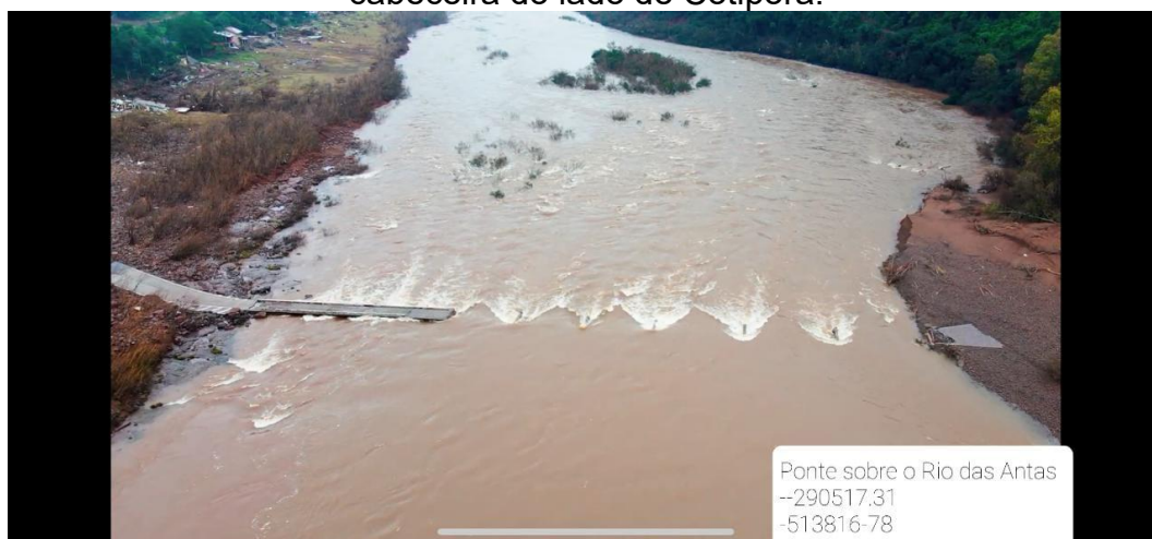
Figura 2 - Imagem da situação da ponte após as enchentes de 2024, no lado esquerdo a cabeceira do lado de Bento Gonçalves e no lado direito a cabeceira do lado de Cotiporã.
