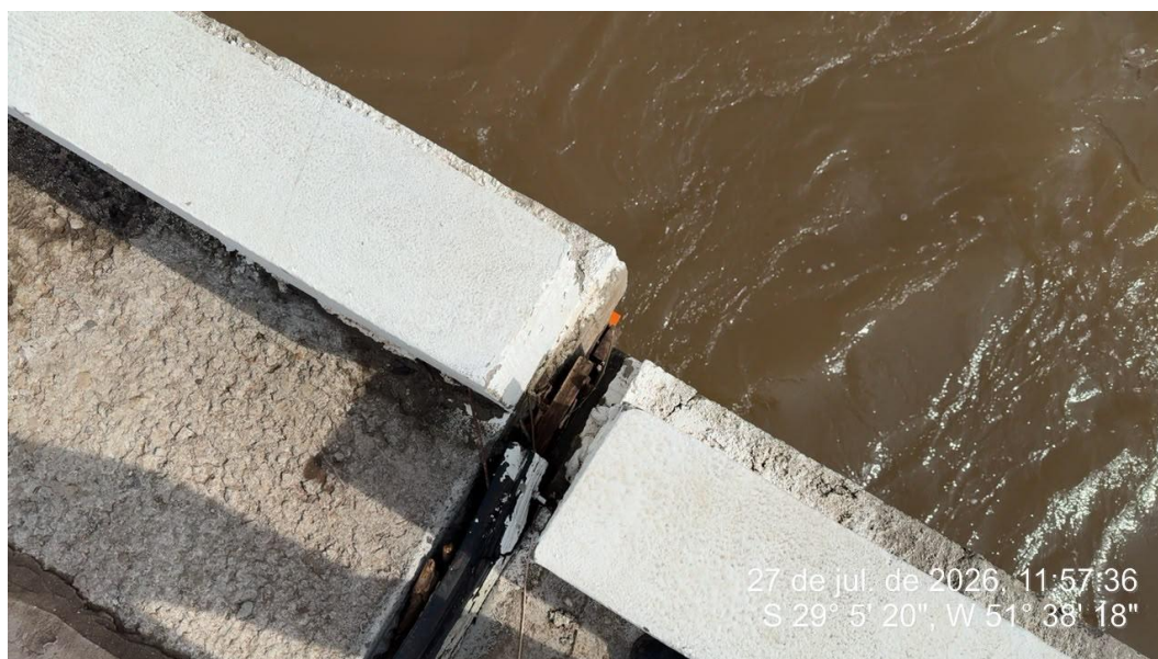
Figura 8 - Deslocamento lateral do tabuleiro
