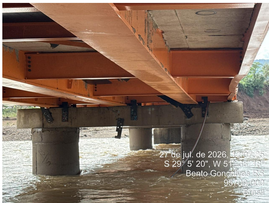
Figura 9 - Identificação dos danos à estrutura da ponte
