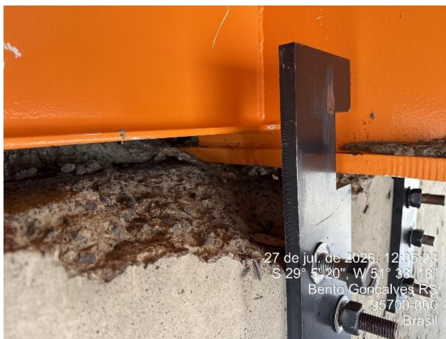
Figura 10 - Identificação de travas de segurança quebradas e arrancamento do concreto do apoio
