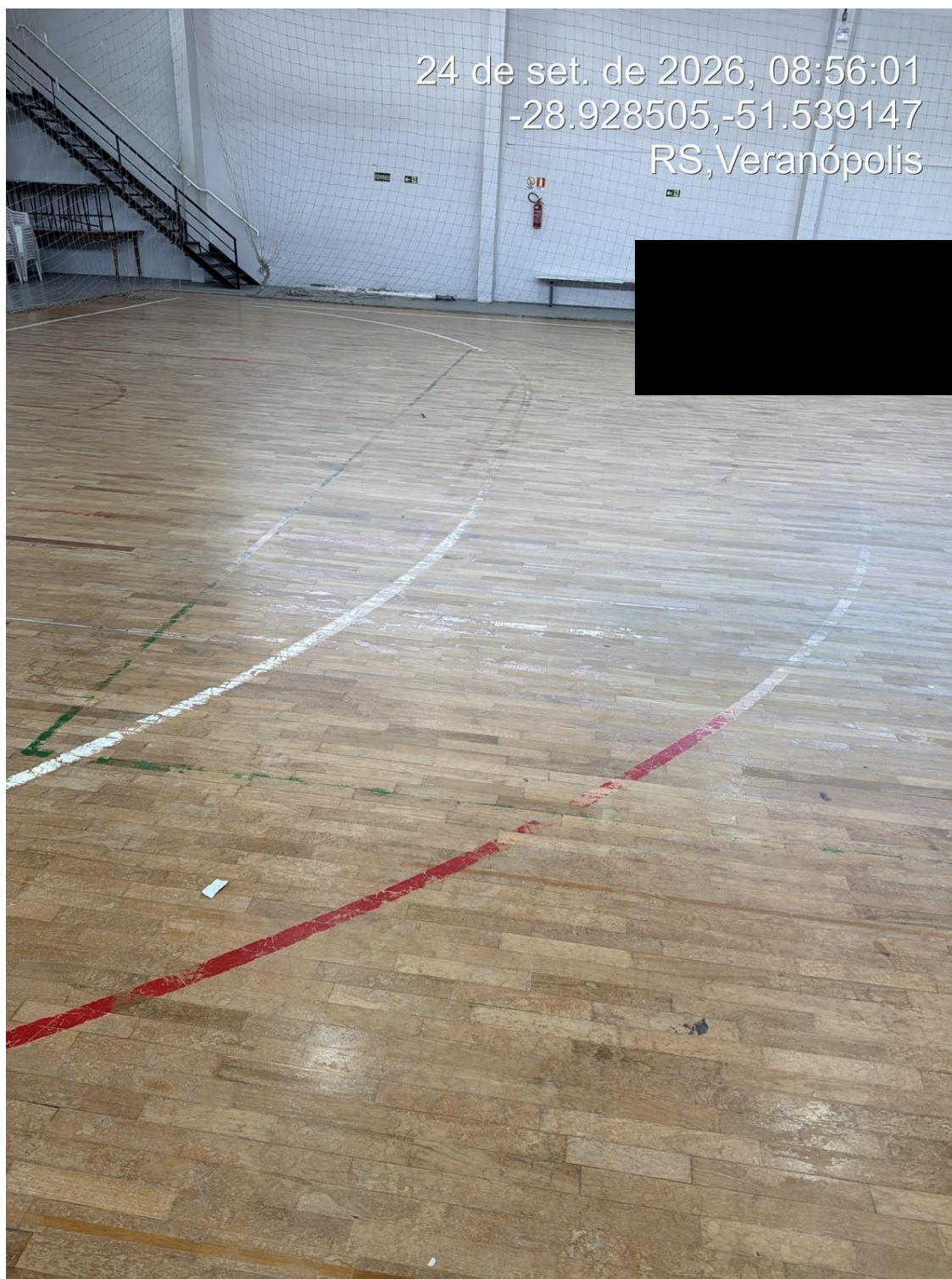
Imagem 3- Piso de madeira com manchas e sinais de deterioração, apresentando desgaste da superfície e ausência de trechos da sinalização da quadra.
