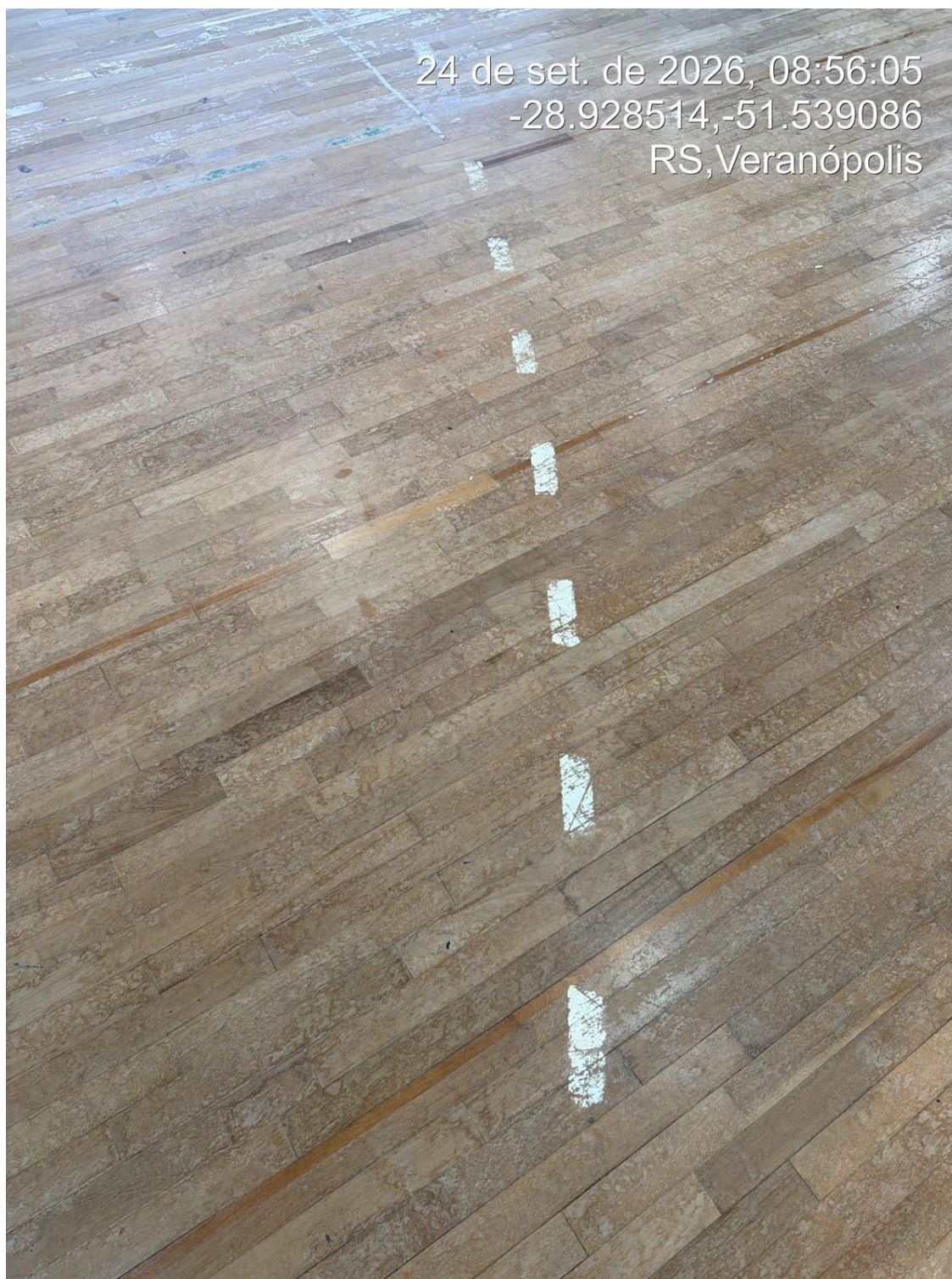
Imagem 1- Piso de madeira com manchas e desgastado
