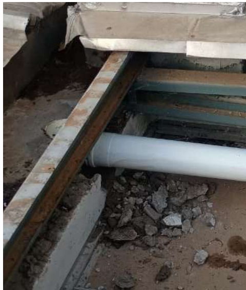
Imagem – Vigas danificadas
