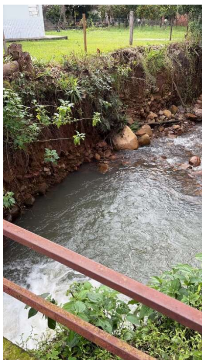
Imagem 2 – talude com erosão, local onde deverá ser construída viga baldrame
