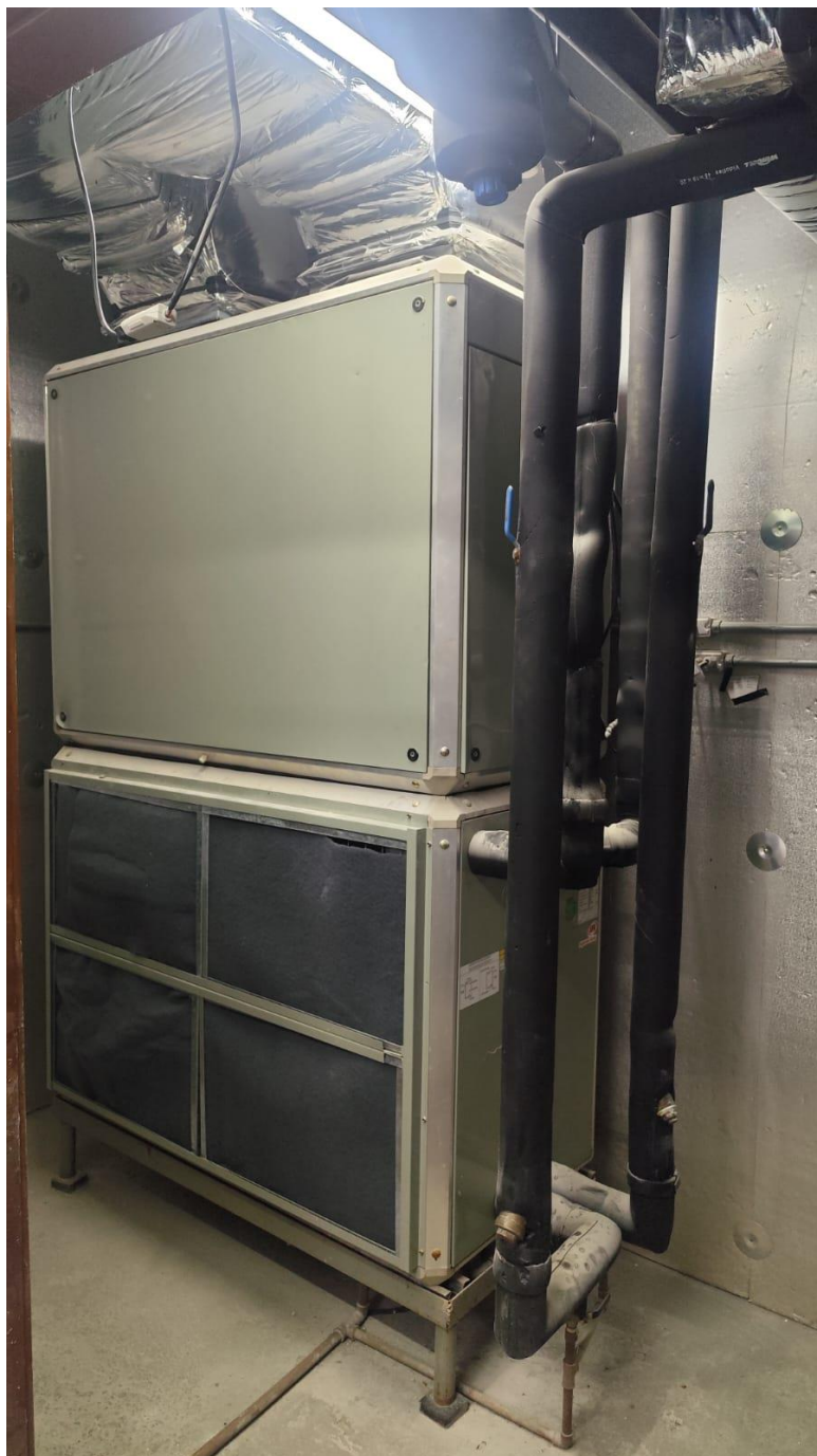
Figura 4 – Fan Coil Vertical em casa de máquinas
