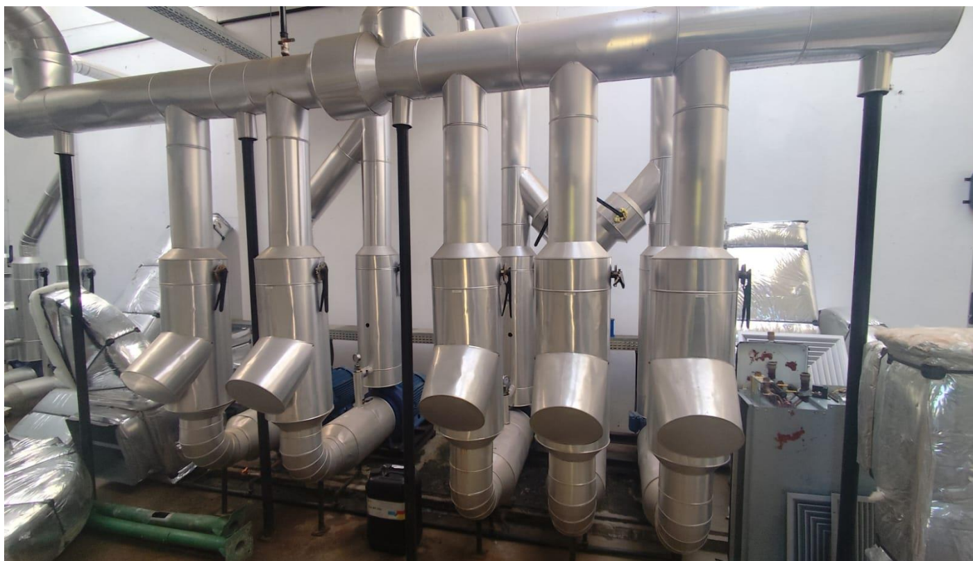
Figura 1 – Central de Água Gelada e Água Quente (motobombas centrífugas)
