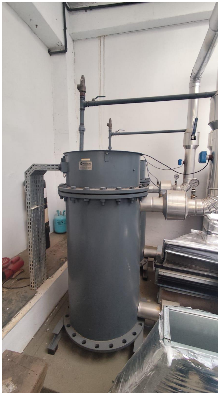
Figura 2 – Central de Água Gelada e Água Quente – Boiler Elétrico
