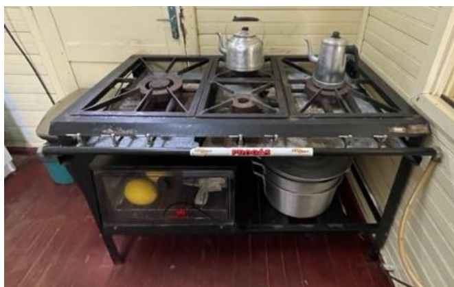
Imagem 27: Fogão industrial da escola que será reaproveitado
