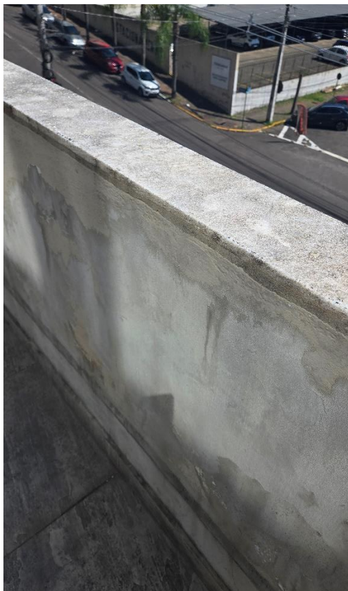
Pingadeiras dos guarda corpos não possuem transpasse interno para caimento adequado da água da chuva.
