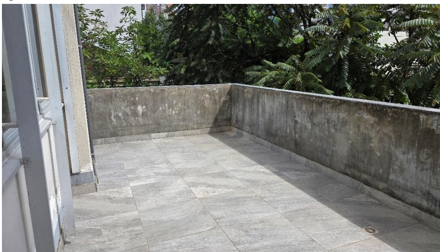
Parte interna das muretas do guarda corpo do 3º pavimento, não possuem tratamento adequado da superfície.
