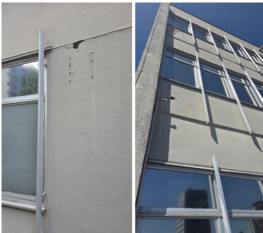
Perfurações junto as fachadas
