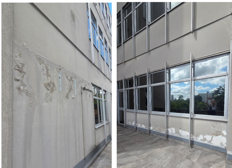
Bolhas e descascamento nas paredes externas do 3º pavimento.
