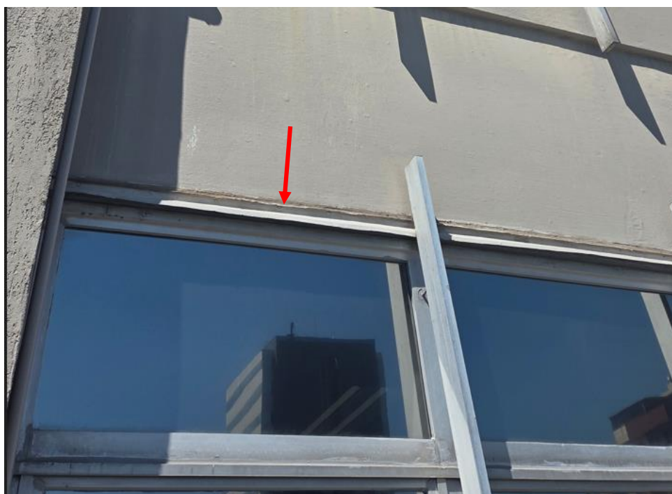
Pingadeiras em chapa metálica danificadas fixadas acima das esquadrias, apresentando perda da sua função e eficiência.
