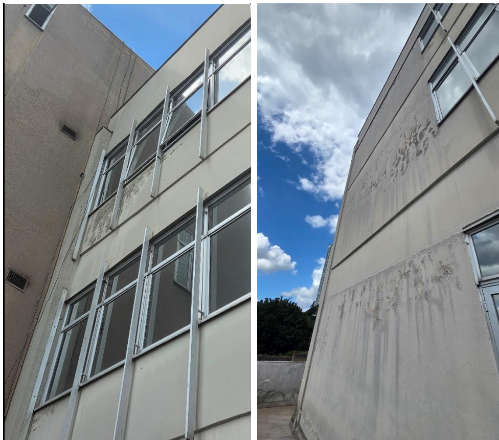
Bolhas e descascamento nas paredes externas do 3º, 4 e 5º pavimento.
