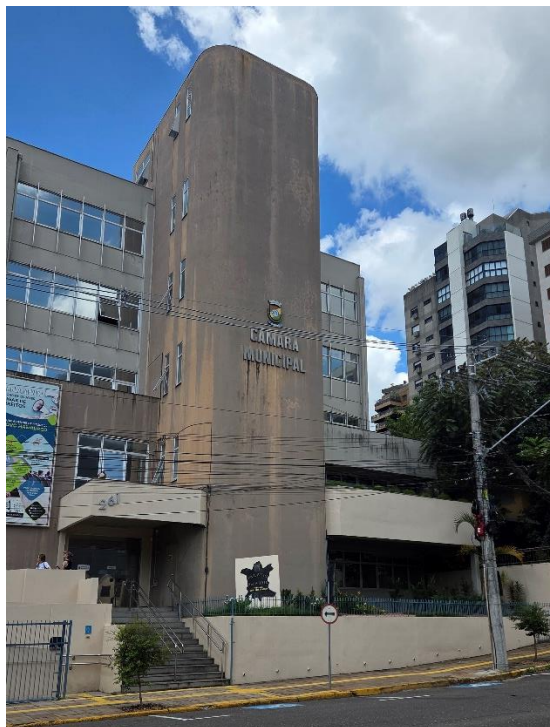
Fachadas com várias manchas de sujeira e escurecimento.
