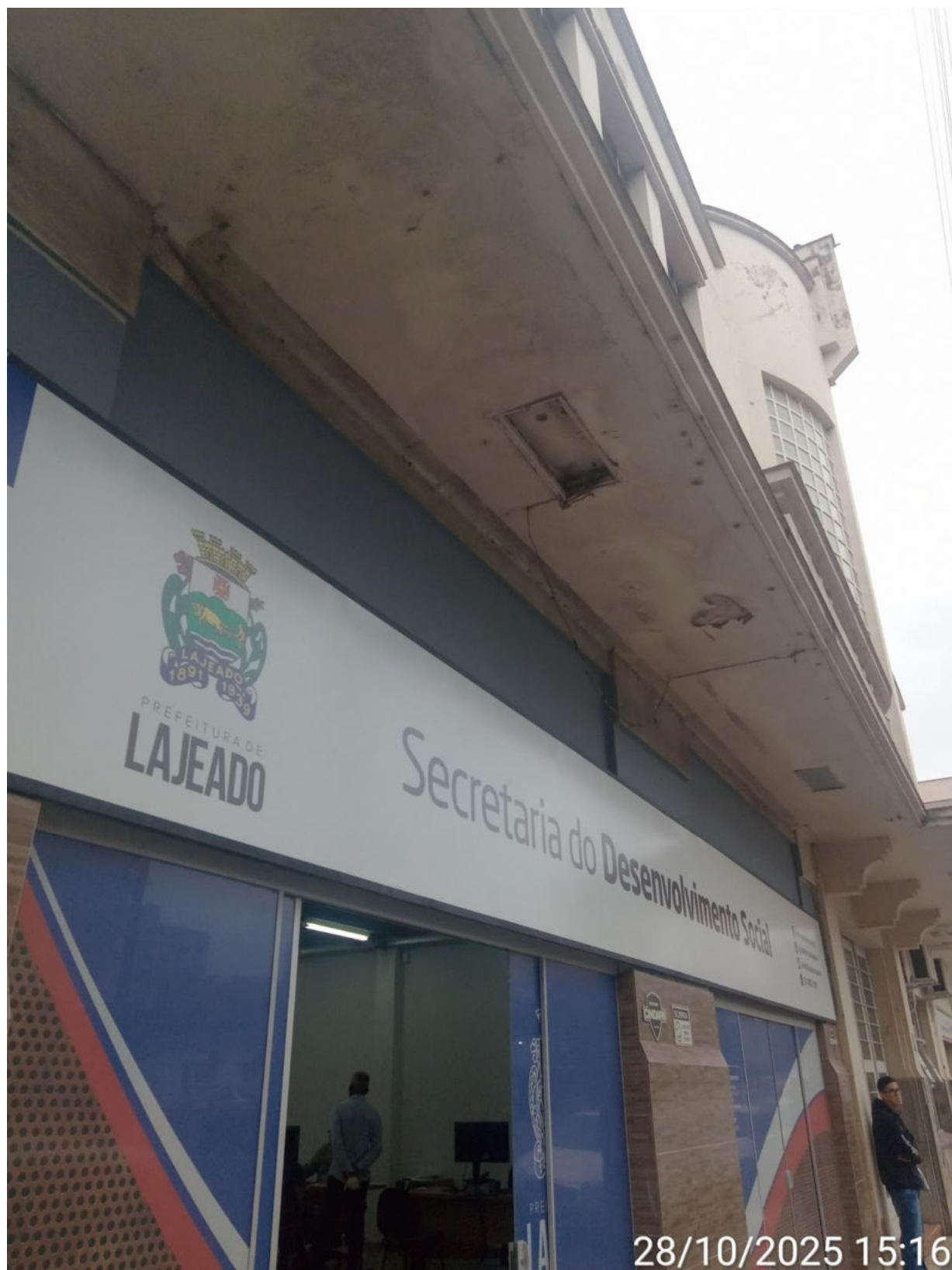
CAIXAS ELÉTRICAS ANTIGAS E REMOÇÃO DE PLACA
