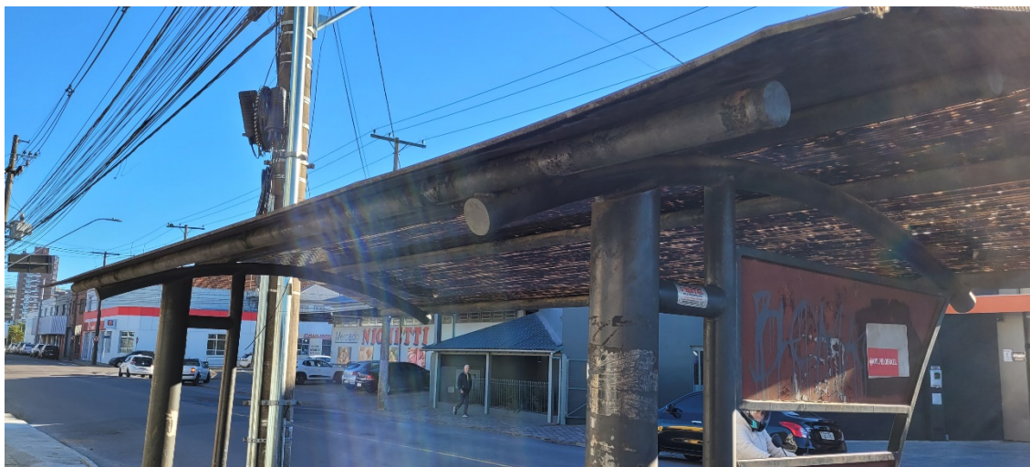
Cobertura de policarbonato totalmente degradada pelo tempo.
