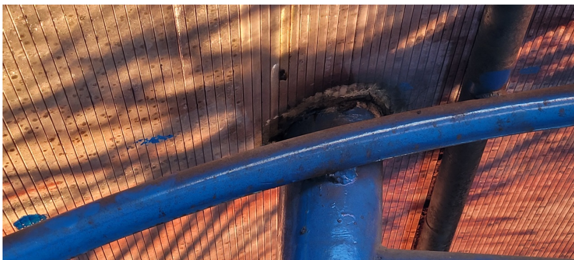
Cobertura de policarbonato desgastada e coluna metálica com oxidação.
