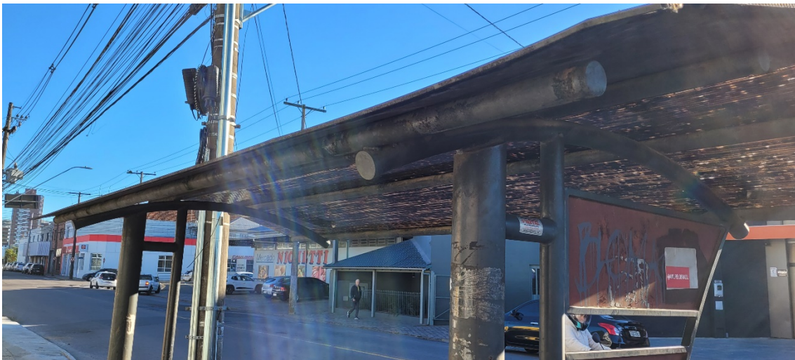
Cobertura de policarbonato totalmente degradada pelo tempo.
