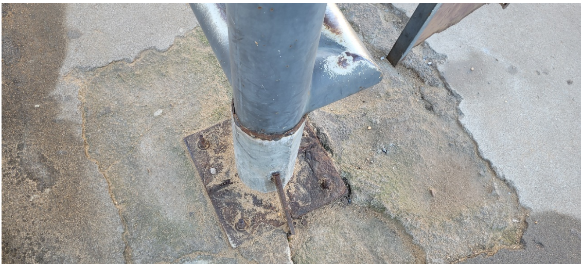
Chapa base sem enrijecedores com corrosão inclusive nos chumbadores. Reparo em tubo galvanizado sem totalidade de solda. Banco sem assento de madeira.
