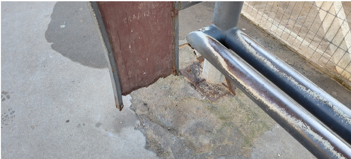
Elemento decorativo alusivo a “vindima” com corrosão e oxidação. Bancos sem o assente de madeira.
