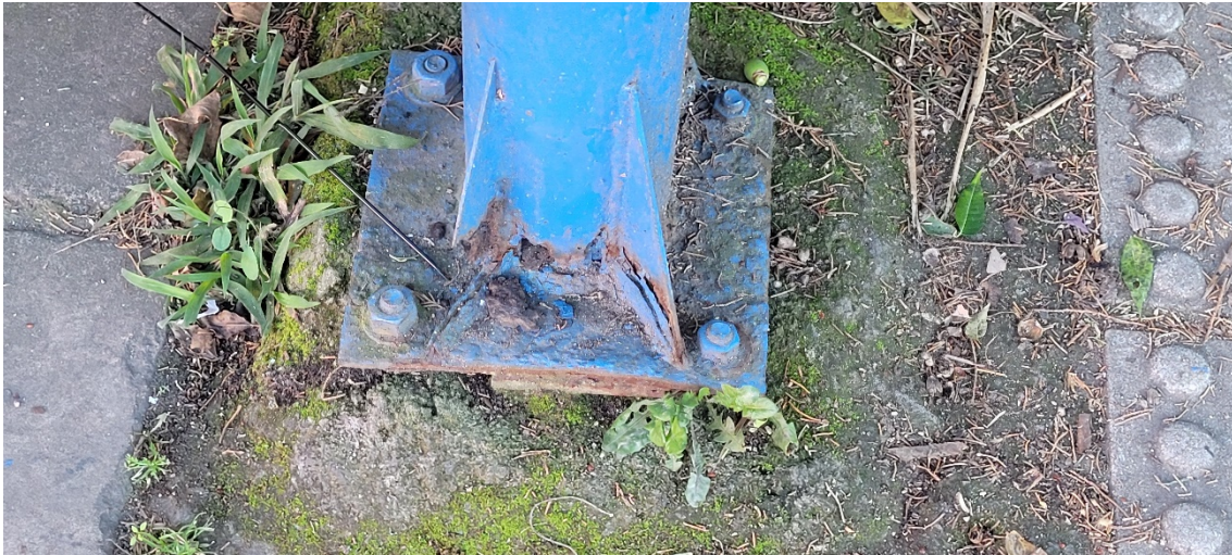
Chapa base e enrijecedores com sinais avançados de corrosão.
