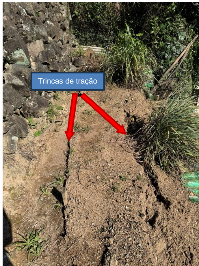
Figura 23: Trincas de tração observadas no topo do talude atrás da residência da Figura 15
