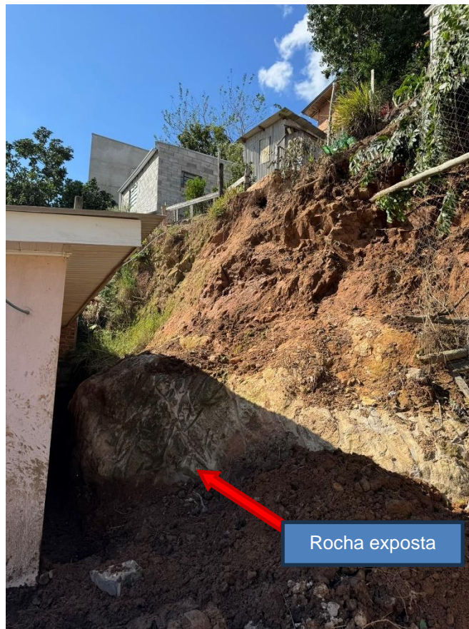
Figura 16: Mesmo talude da Figura 15 sob outro ângulo, com exposição da rocha
