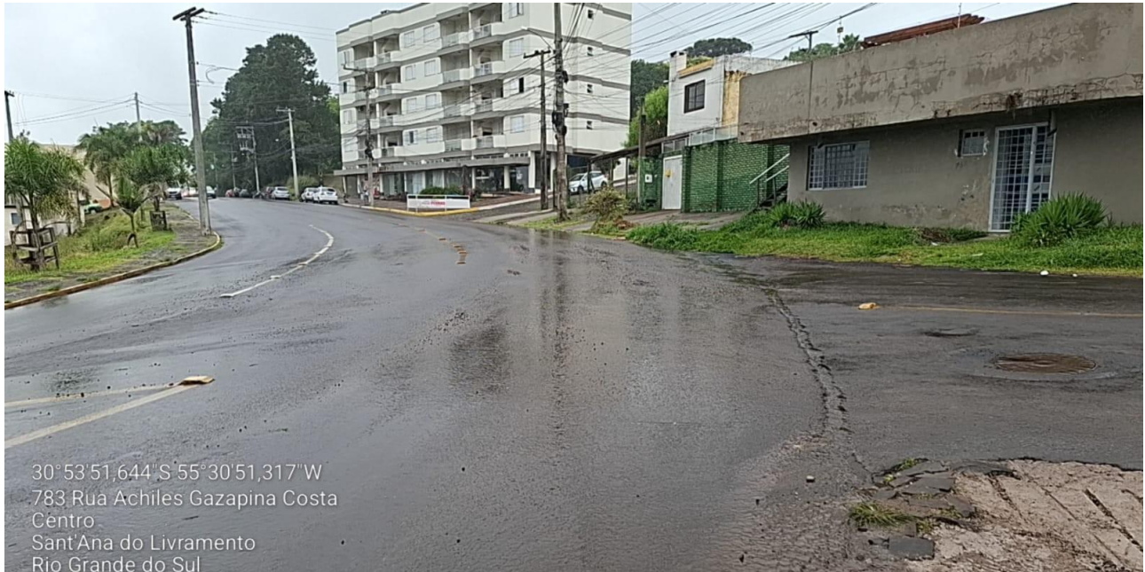
Figura 4 - Registro do sentido centro para bairro - Av. Francisco R. A. Góes – Locais de drenagem e local onde haverá camada de rolamento nova.
