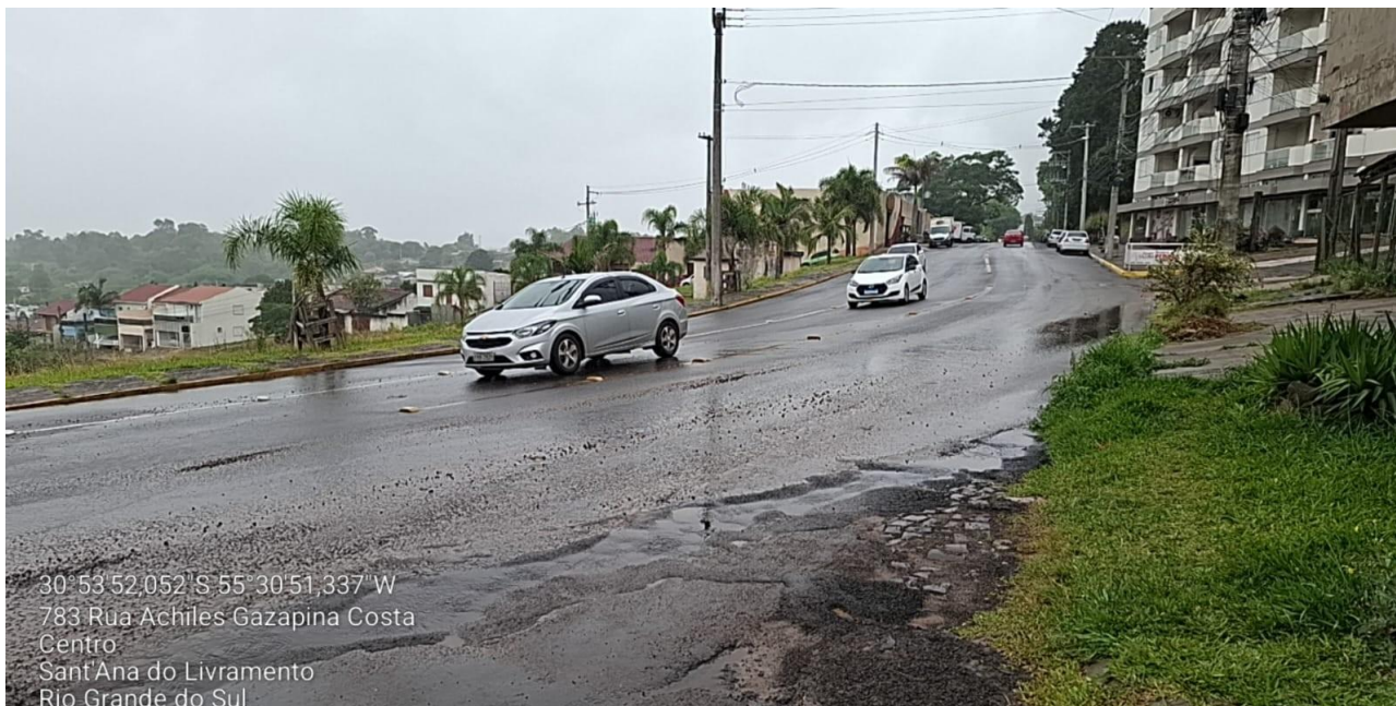
Figura 6 - Registro do sentido centro para bairro - Av. Francisco R. A. Góes – Locais de drenagem e local onde haverá camada de rolamento nova.
