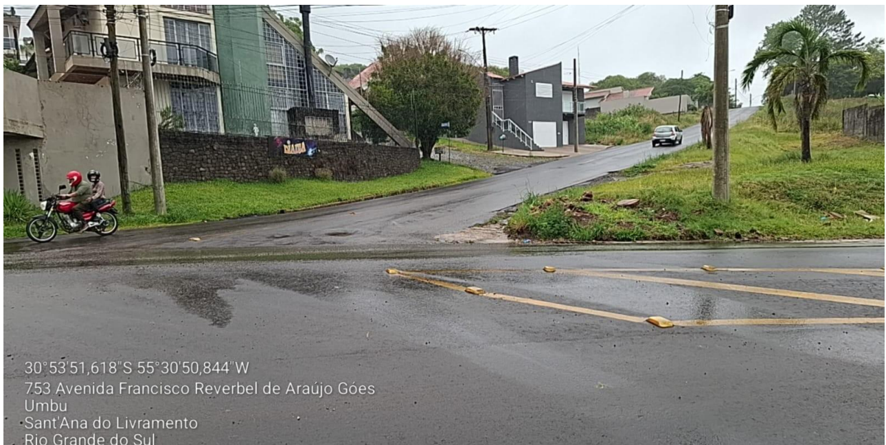
Figura 5 - Registro do sentido centro para bairro - Av. Francisco R. A. Góes – Locais de drenagem e local onde haverá camada de rolamento nova.
