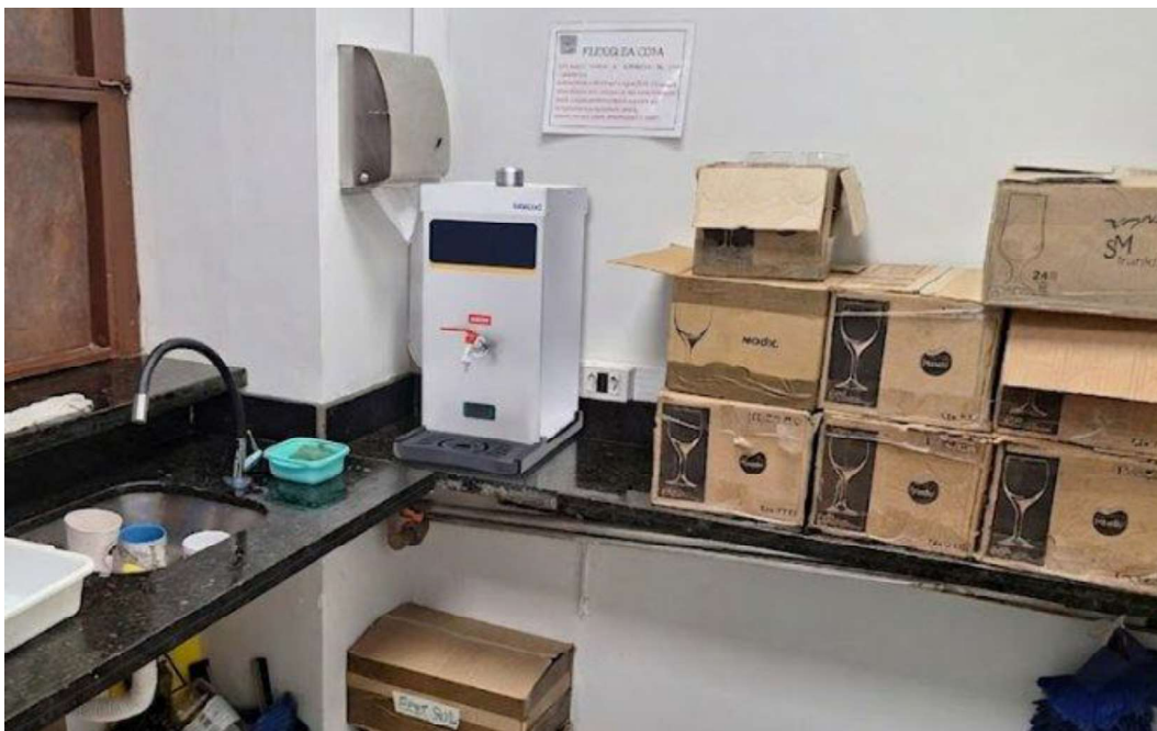
Figura 5- Copa do T Cultural Tereza Franco: local previsto para instalação do terminal de aquecimento de água.
