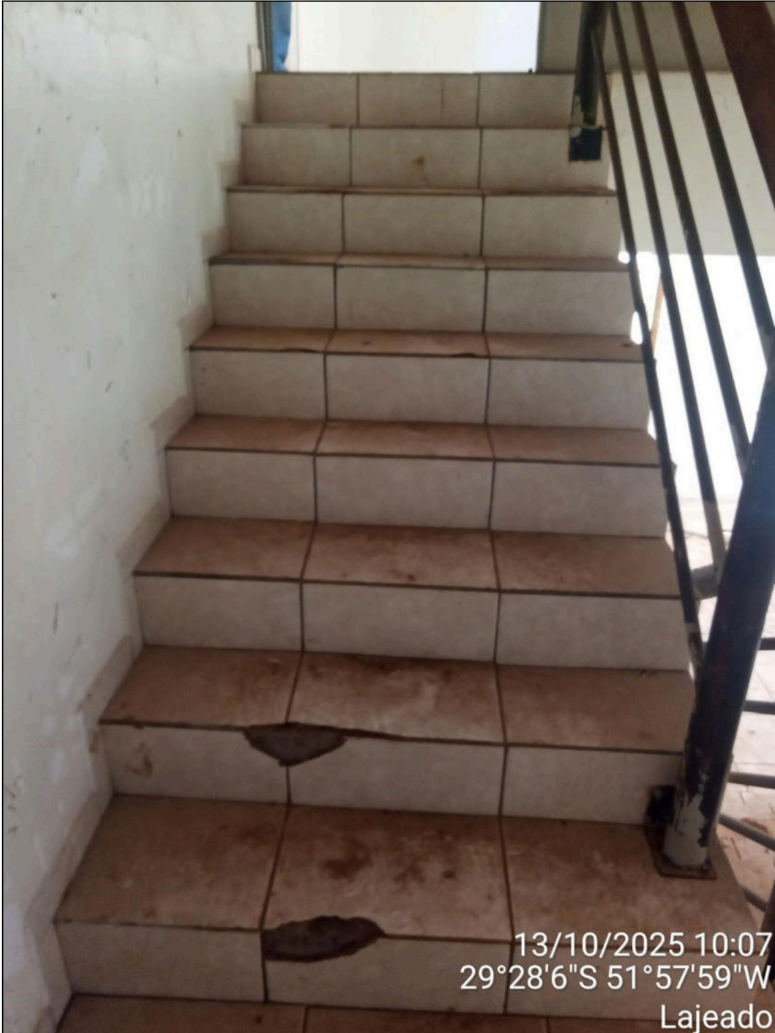
Imagem - Degraus danificados
