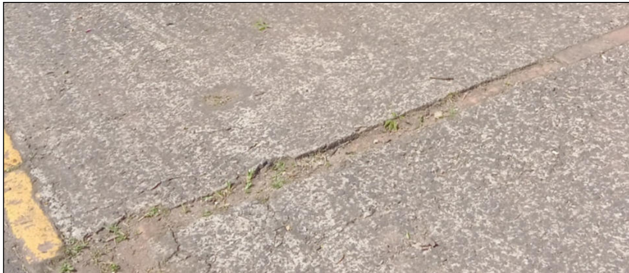
Imagem - Ausência de tijolos
