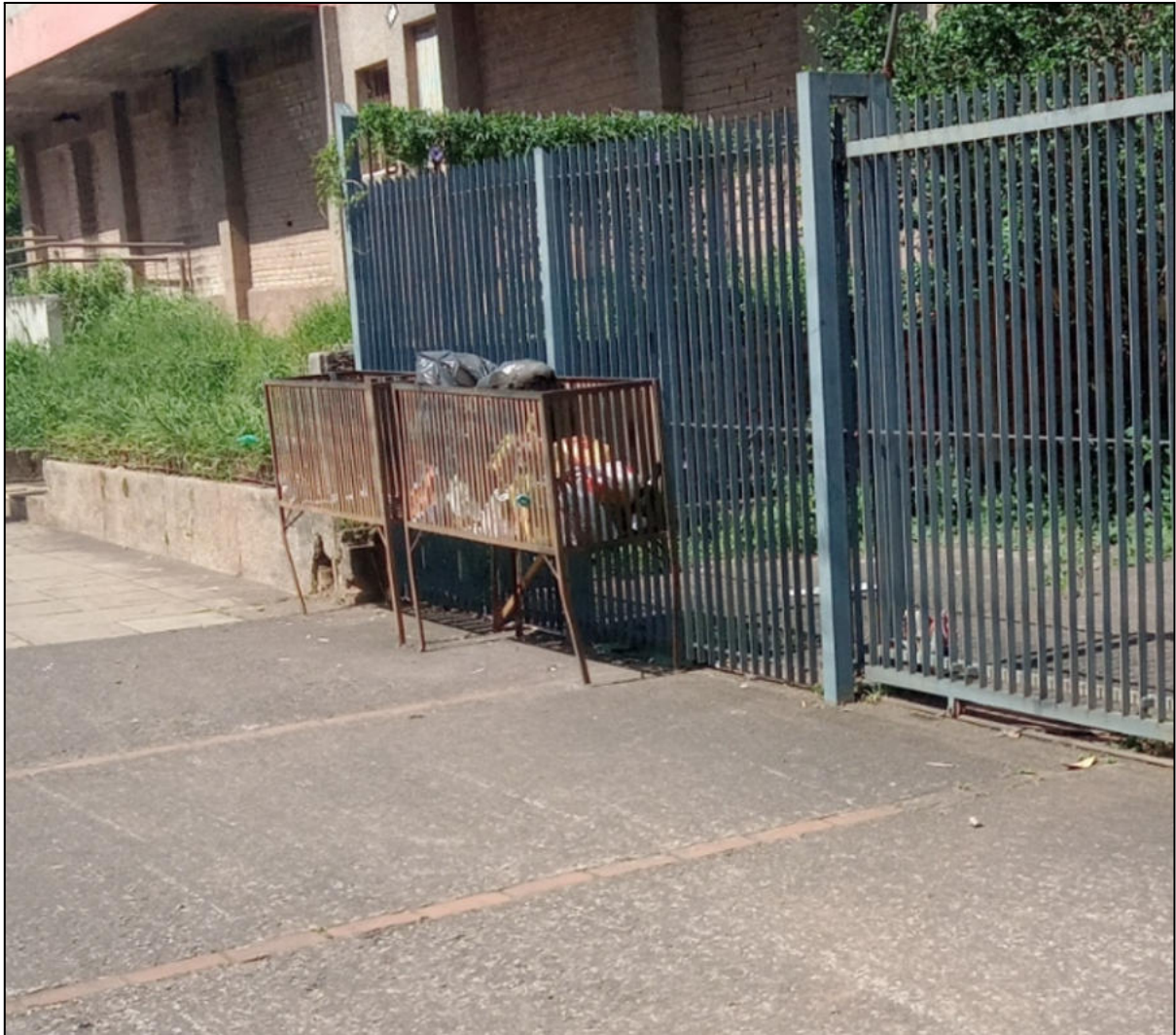
Imagem - Retirada de lixeiras e adaptação da grade em portão de correr
