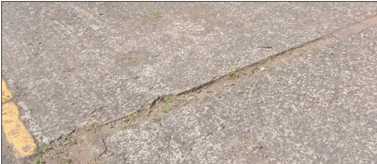
Imagem - Ausência de tijolos
