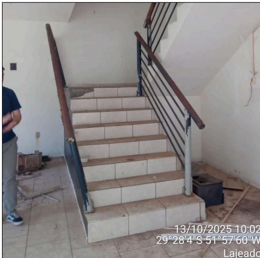
Imagem - Escada com guardas danificadas
