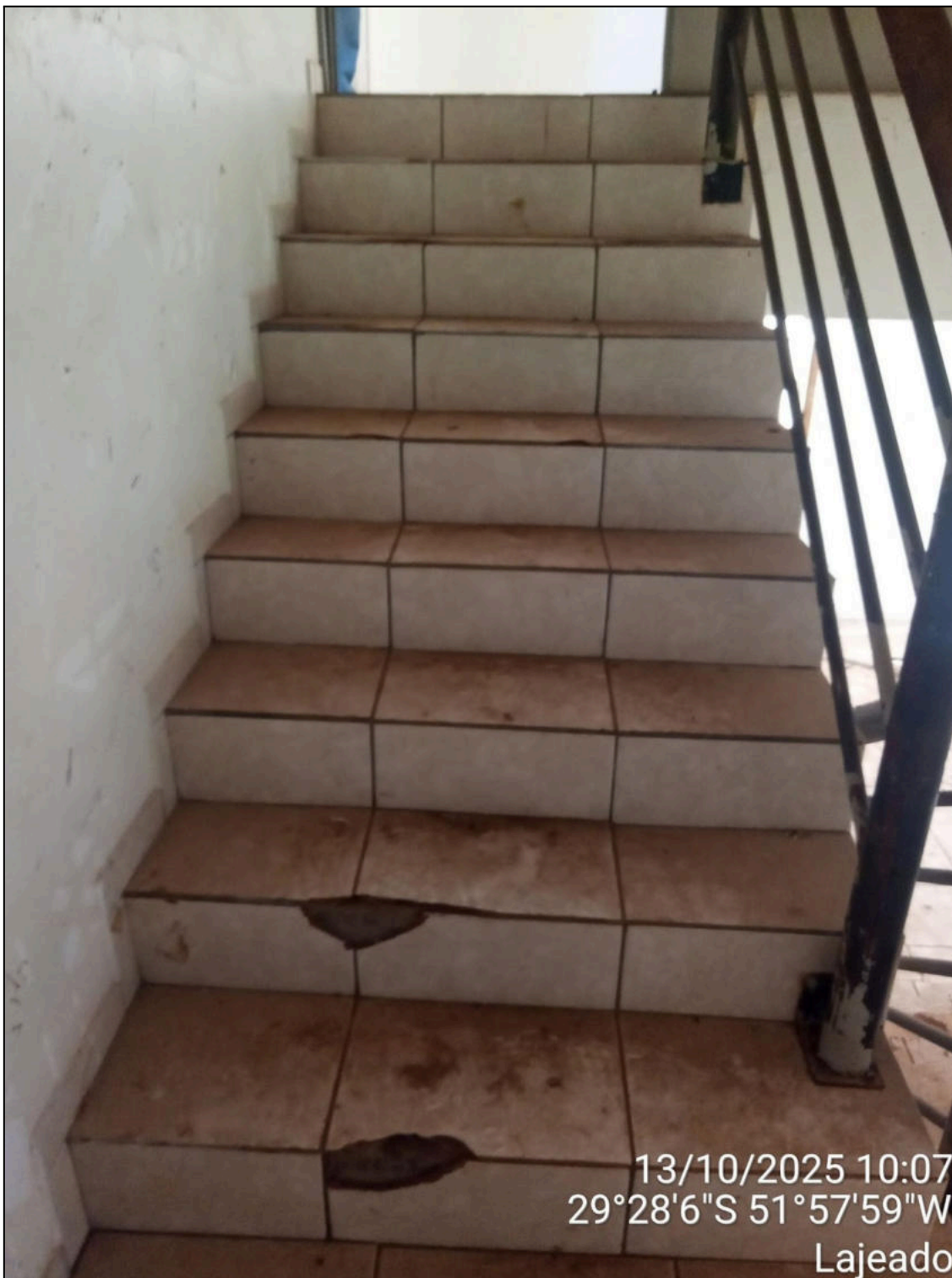
Imagem - Degraus danificados
