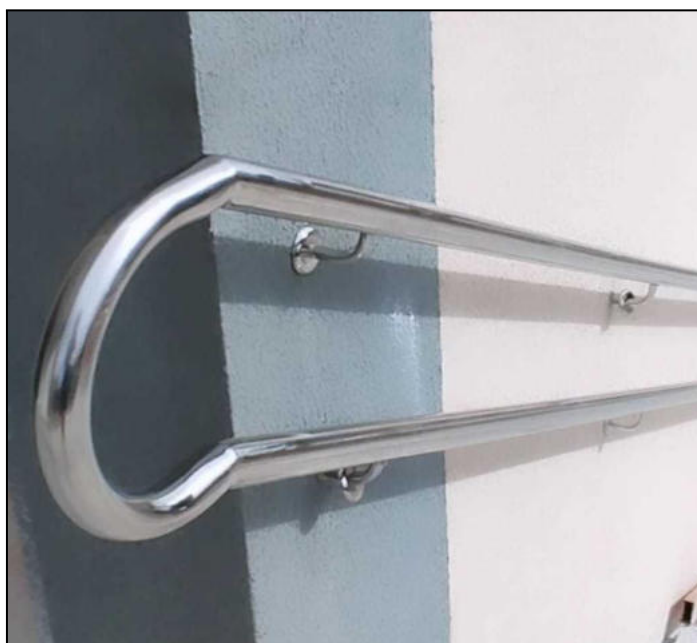
Imagem - Corrimão de parede
