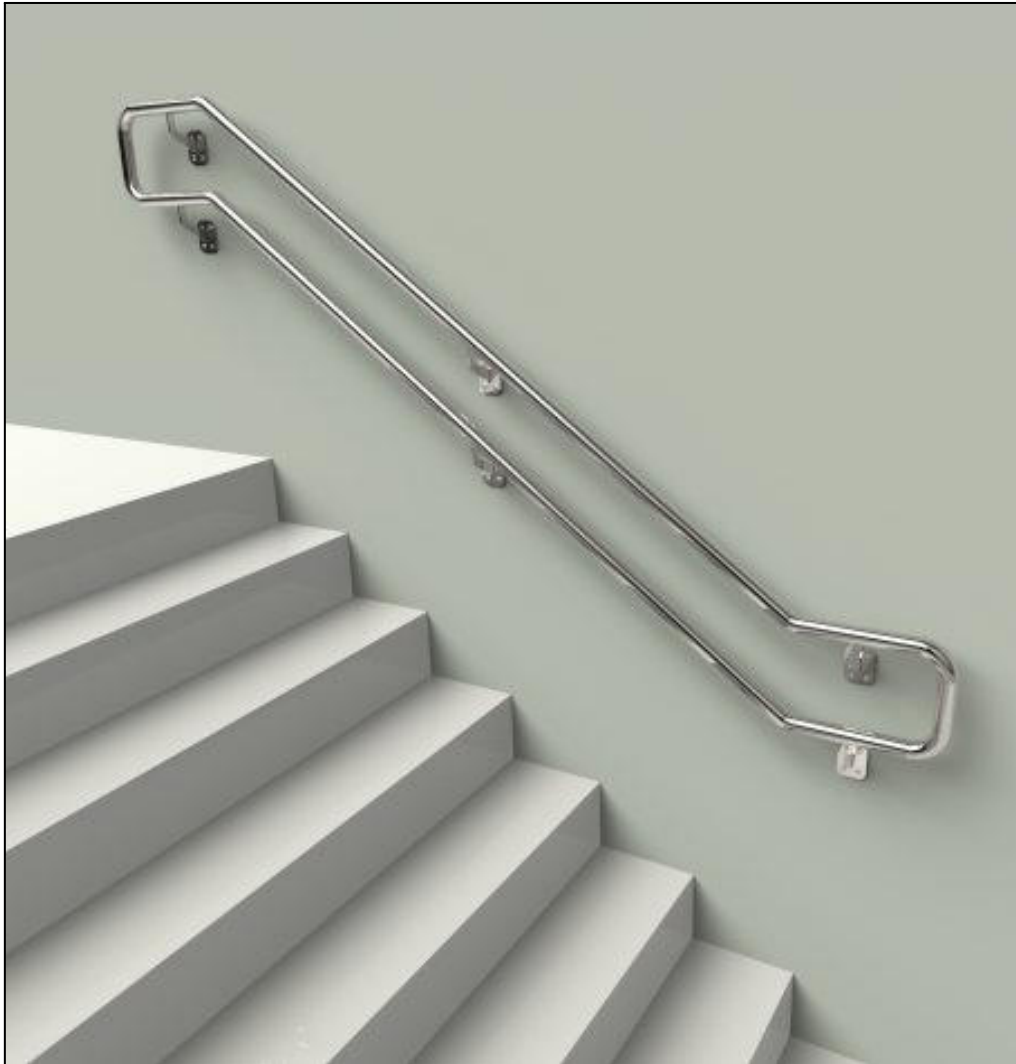
Imagem - Corrimão de parede
