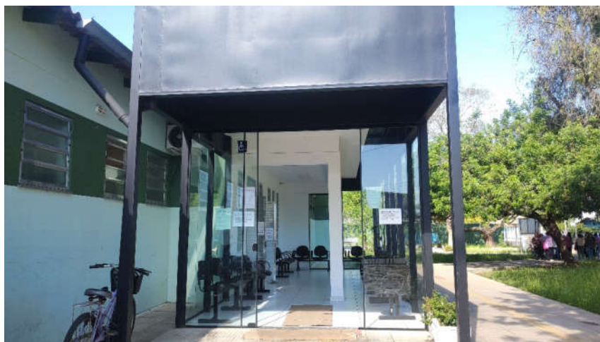
Figura 11: Portas de acesso à UBS danificadas e com folhas ausentes (09.10.2025).
