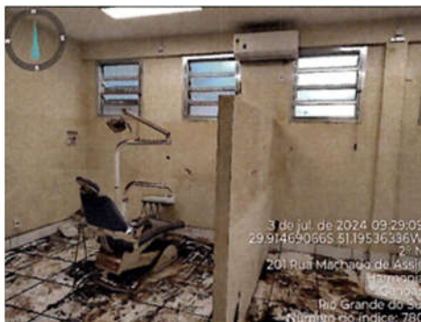
Figura 05: Consultório odontológico com revestimento deteriorado em 03.07.2024. Fonte: Laudo CREA/RS.
