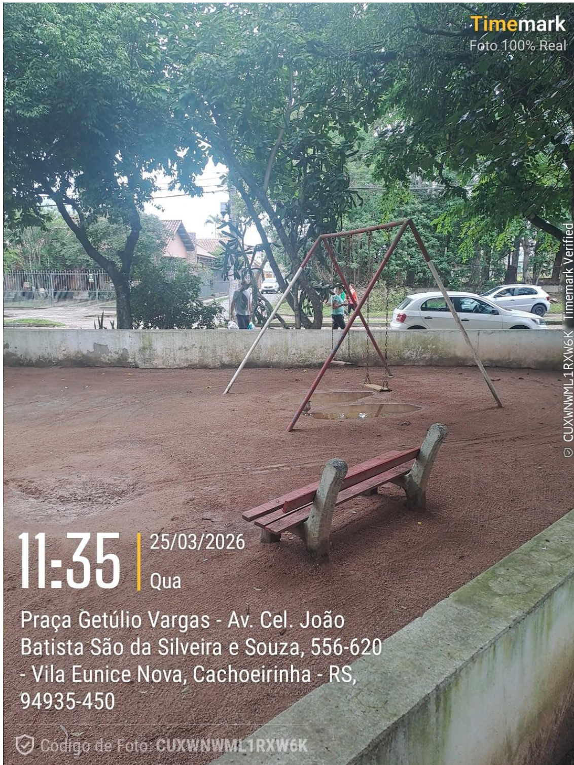
Foto 24: Vista parcial da área de recreação infantil. Observa-se balanço com estrutura metálica apresentando pontos de corrosão e desgaste na pintura.
