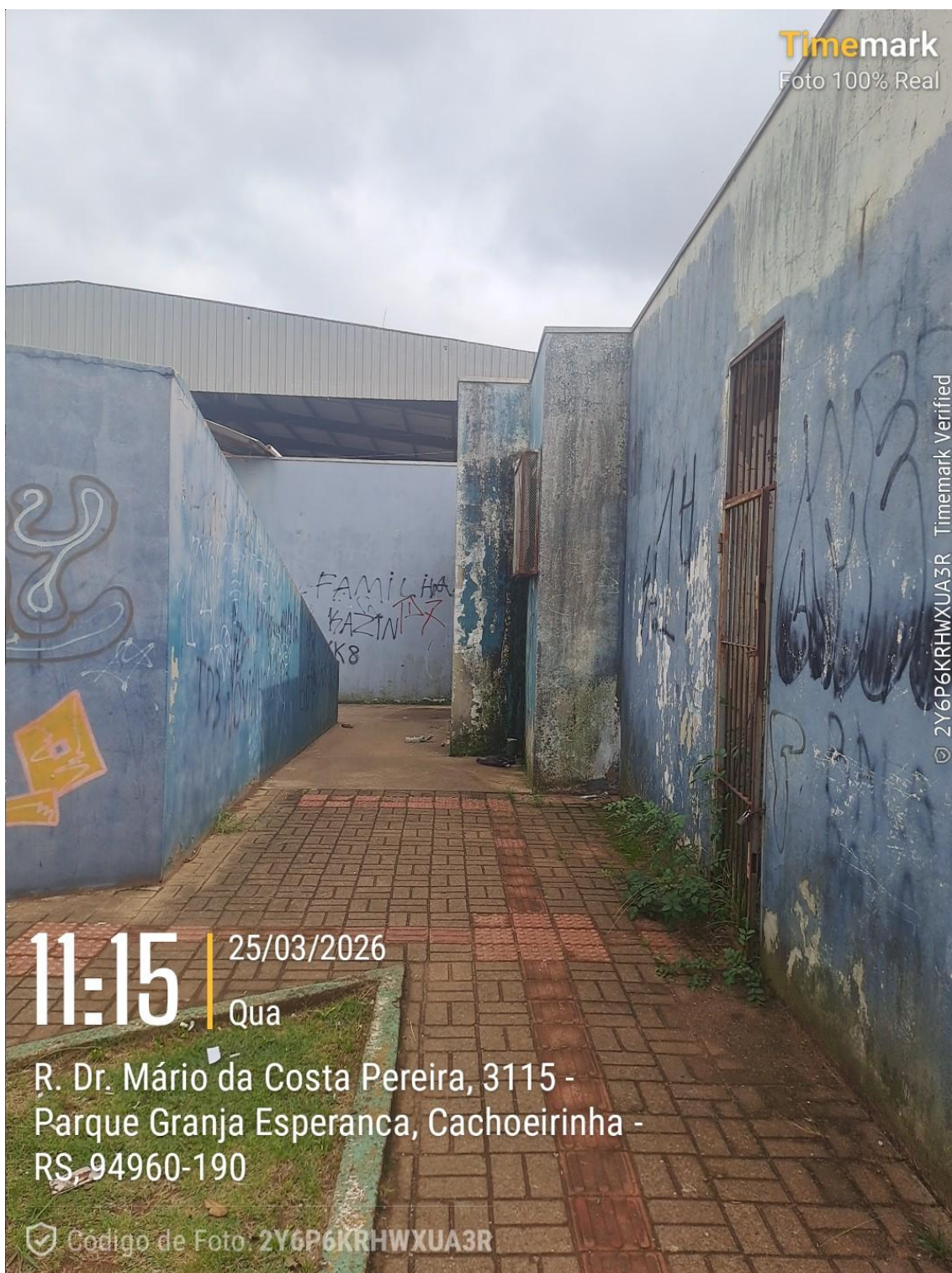
Foto 16: Construções da Praça da Juventude com pichações e sinais de degradação na pintura
