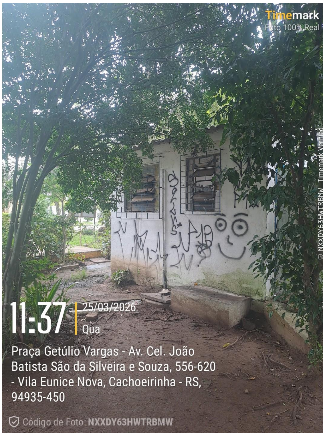
Foto 25: Fachada de edificação do sanitário. Estado crítico de conservação com presença generalizada de pichações, infiltrações externas e esquadrias metálicas danificadas.
