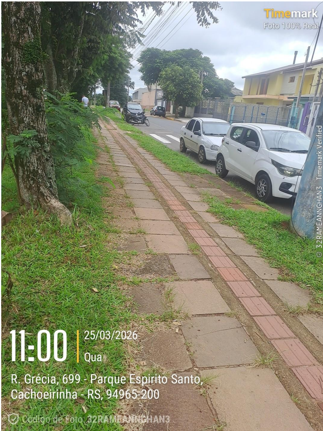
Foto 4: Condições do passeio público Praça da Bíblia.
