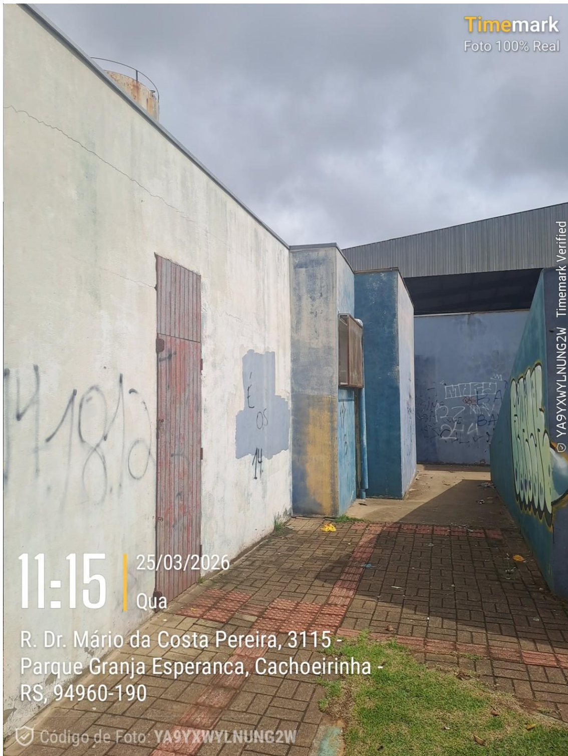
Foto 19: Construções da Praça da Juventude com pichações e sinais de degradação na pintura
