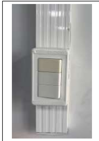
Figura 28: Fixação de tampa terminal
