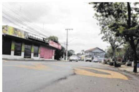
Asfalto desgastado e com desnível em quebra-mola
