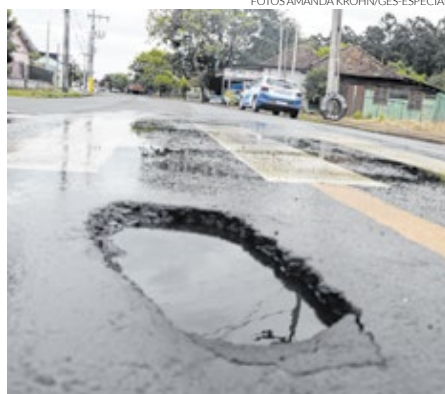
Vazamento de água causou erosão e Corsan vai consertar
