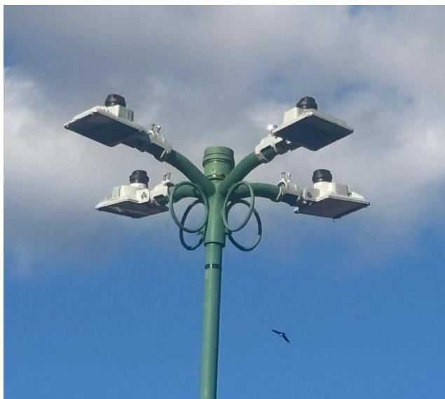
Figura 7: Núcleo existe para quatro luminárias.
