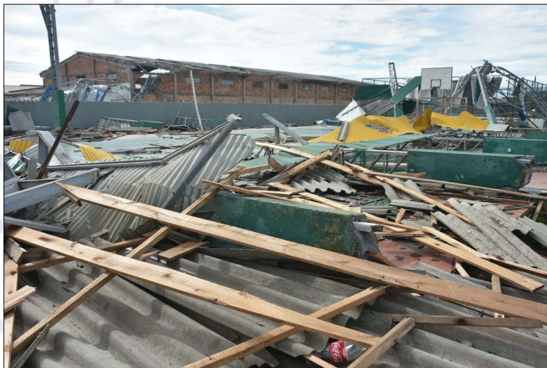
Figura 2: Vista do Ginásio após a tempestade (registro do dia 18/02/2025)
