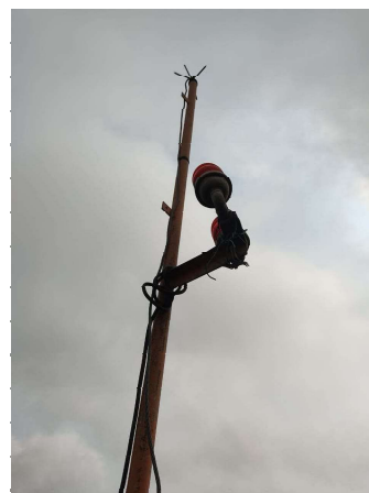
FOTO 34 Balizamento noturno inoperante
