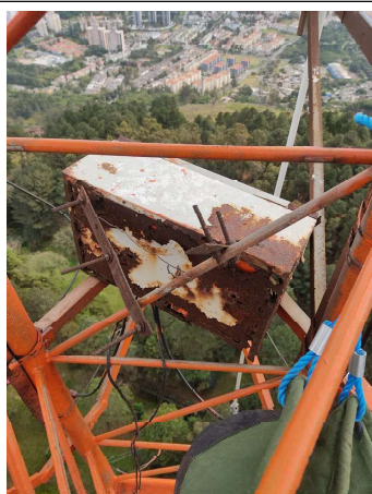
FOTO 33 Pintura descascada e com ferrugem
