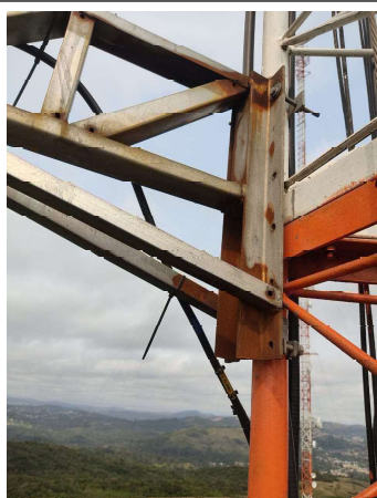
FOTO 21 Ferrugem na estrutura
