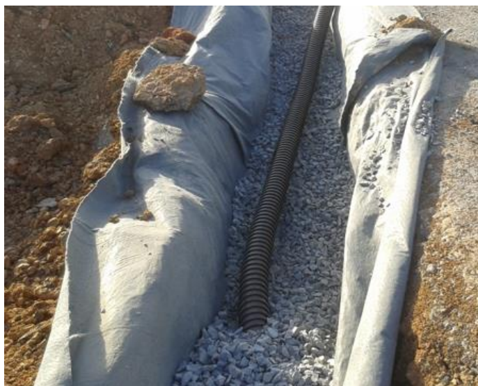
Figura 1 – Instalação de manta drenante com tudo PEAD e preenchimento em pedra britada.
