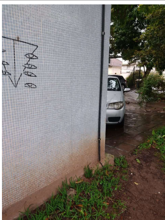
FOTO 11 Cabo do aterramento
