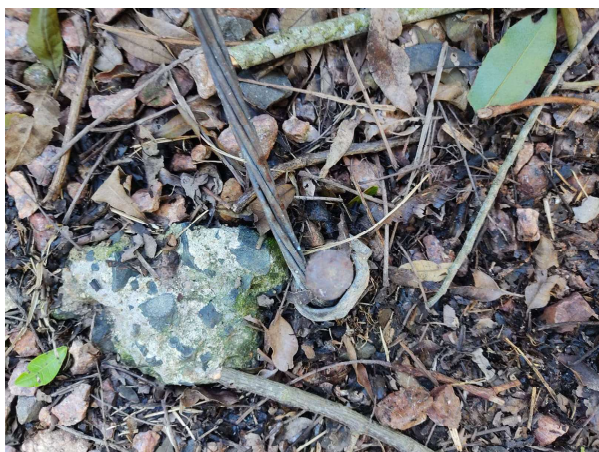
FOTO 3 Aterramento – ações da oxidação
