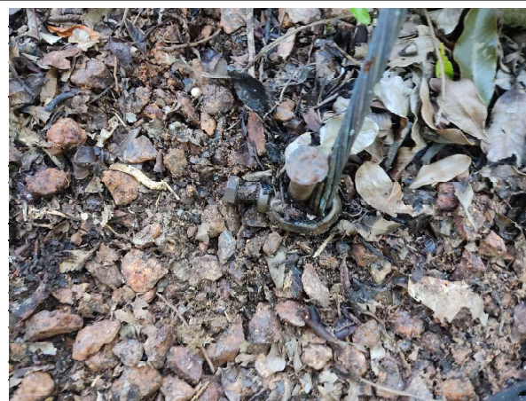
FOTO 4 Aterramento – ações da oxidação
