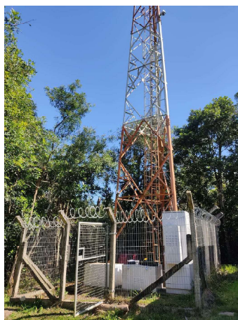
FOTO 1 Torre autoportante de 30m
