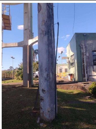
FOTO 3 Cabo de descida do aterramento
