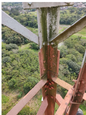
FOTO 13 Processo de oxidação da pintura
