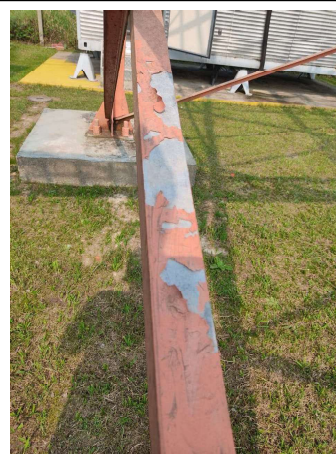
FOTO 8 Pintura desgastada e descascando
