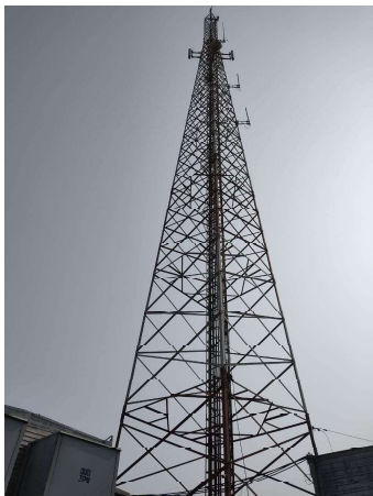
FOTO 1 Torre autoportante de 50m
