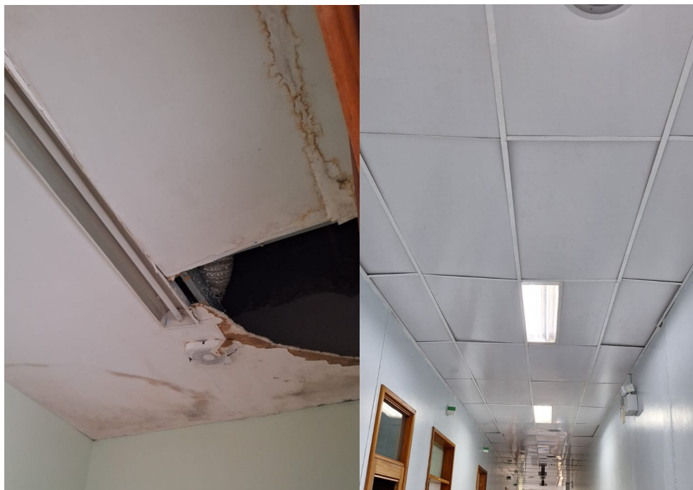
Figuras 18 e 19: Forro do expurgo danificado e com sinais de infiltração e forro da circulação.
