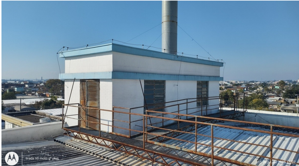
Figura 8: Corrosão das passarelas metálicas e esquadrias do volume superior.
