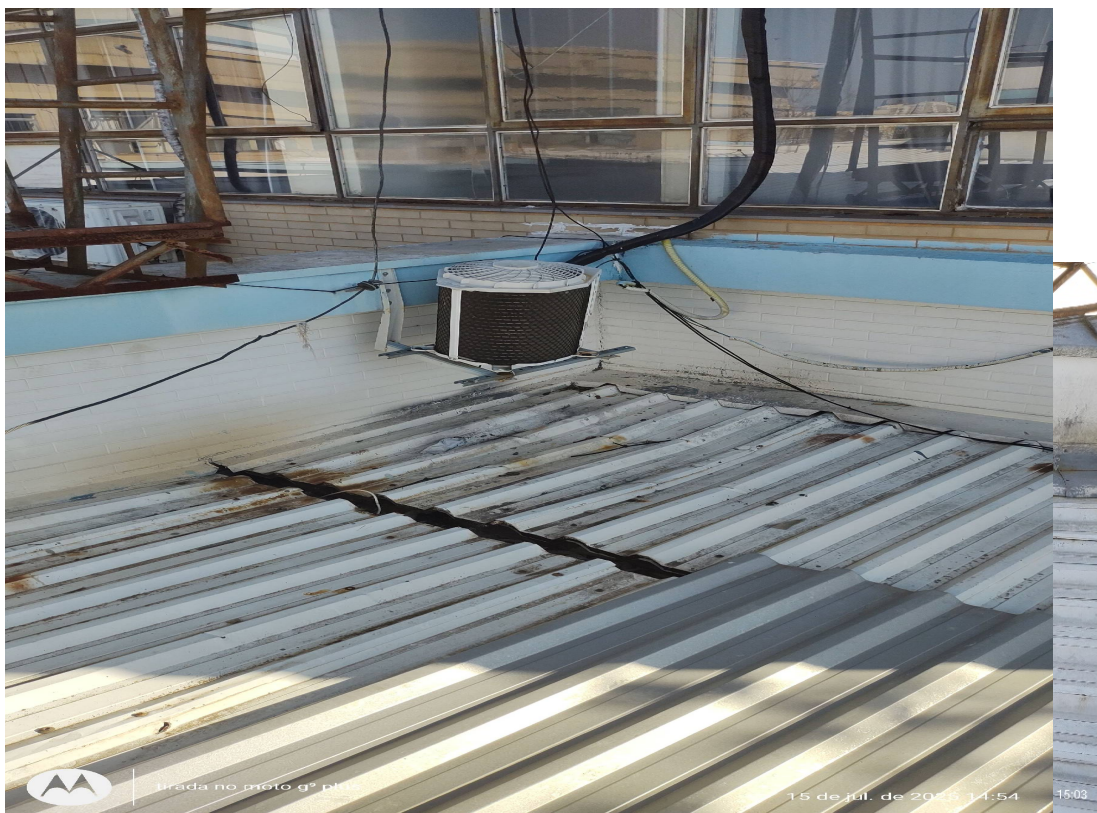
Figura 10: Cobertura apresentando telhas sobrepostas não fixadas, como solução precária a vazamentos.
