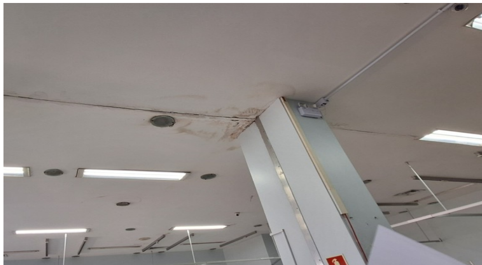
Figura 20: Forro da UTI com sinais de infiltração e deterioração.
