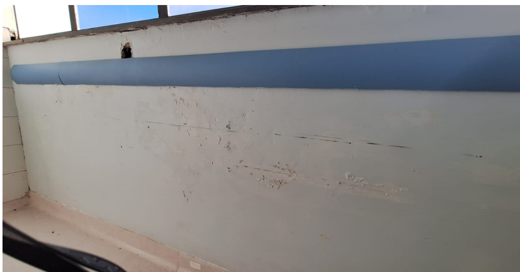
Figura 21: Paredes com desgaste
