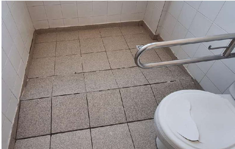
Figura 17: Revestimento apresentando descolamento nos sanitários.
