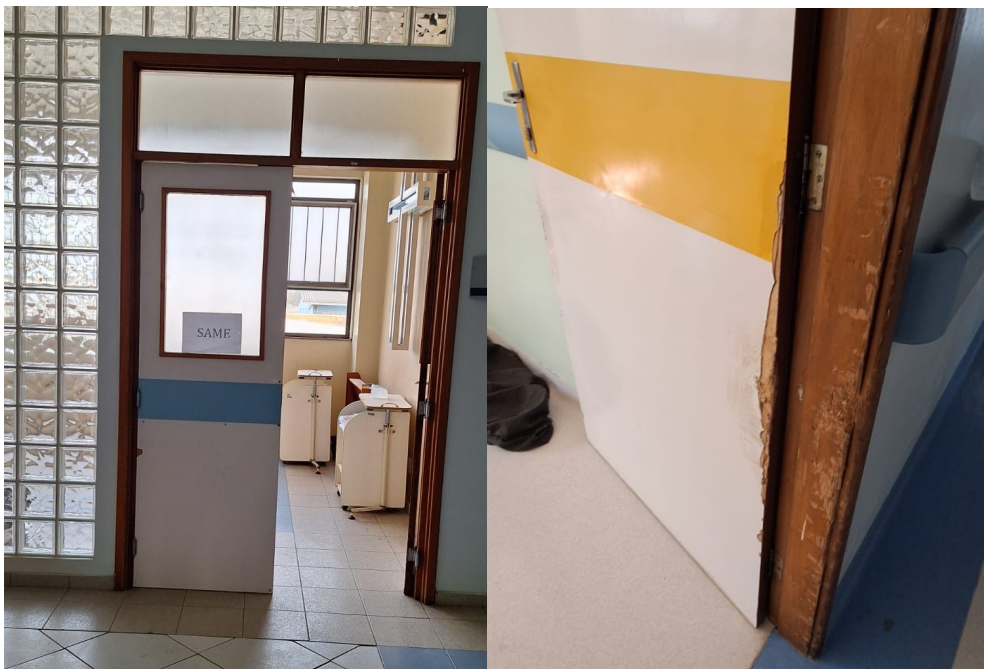
Figuras 14 e 15: Portas da capela e da enfermagem com sinais de desgaste e deterioração.
