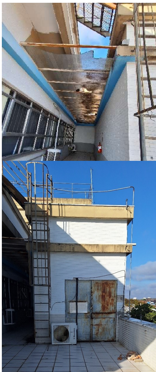
Figuras 12 e 13: Cobertura de vidro danificada no terraço, esquadria e estruturas metálicas apresentando corrosão.
