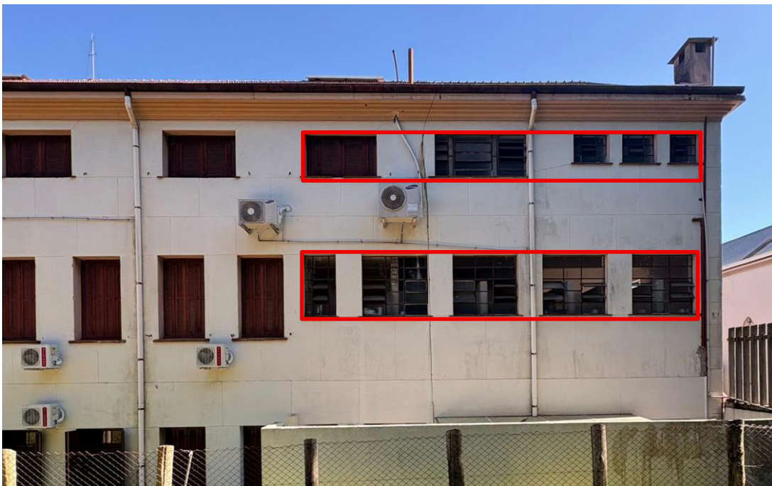
Figura 40 – Foto atual da fachada Nordeste, onde serão substituídas as esquadrias
