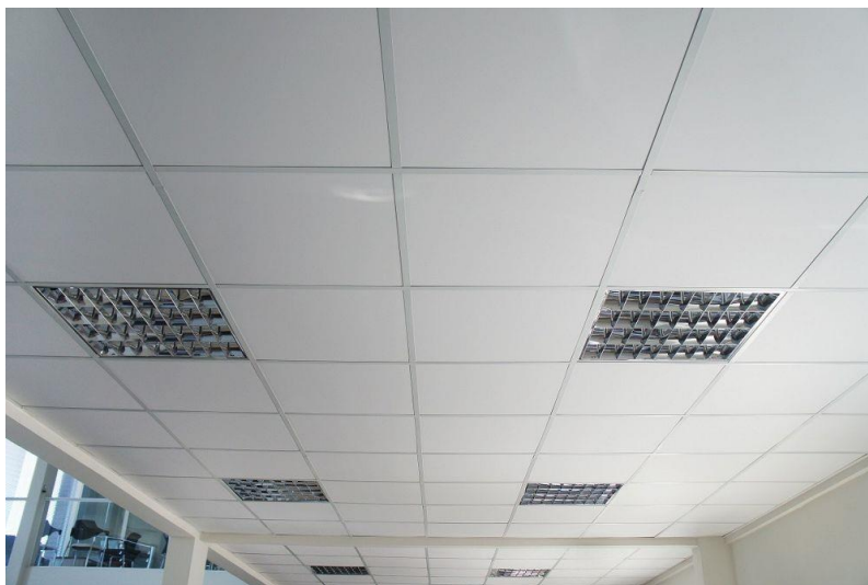
Figura 44 - Referência de forro de gesso modular com película de PVC. Módulos com luminárias embutidas.
