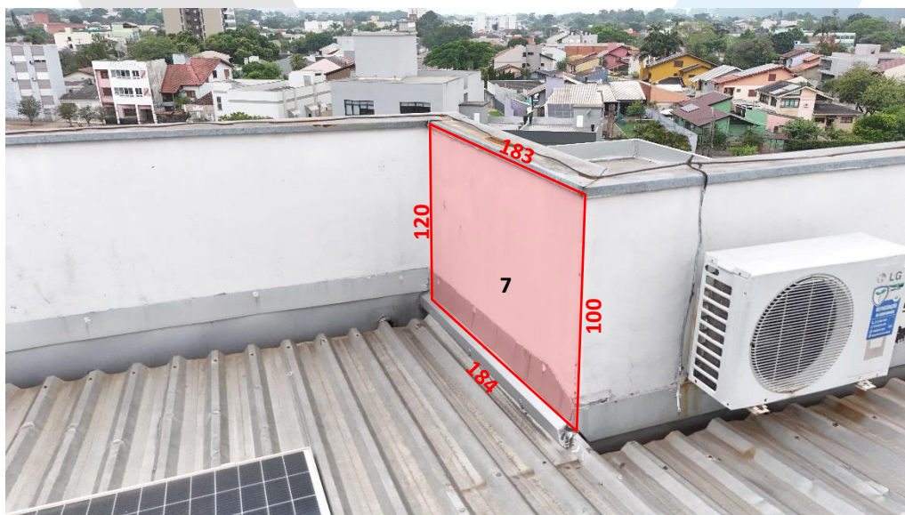
Foto 43 – Medidas da platibanda 7 em cm.
