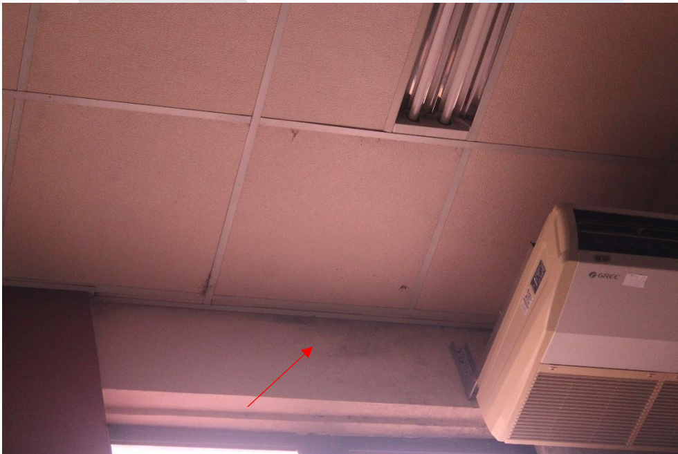
Foto 67- Sinais de infiltração nas paredes do auditório.
