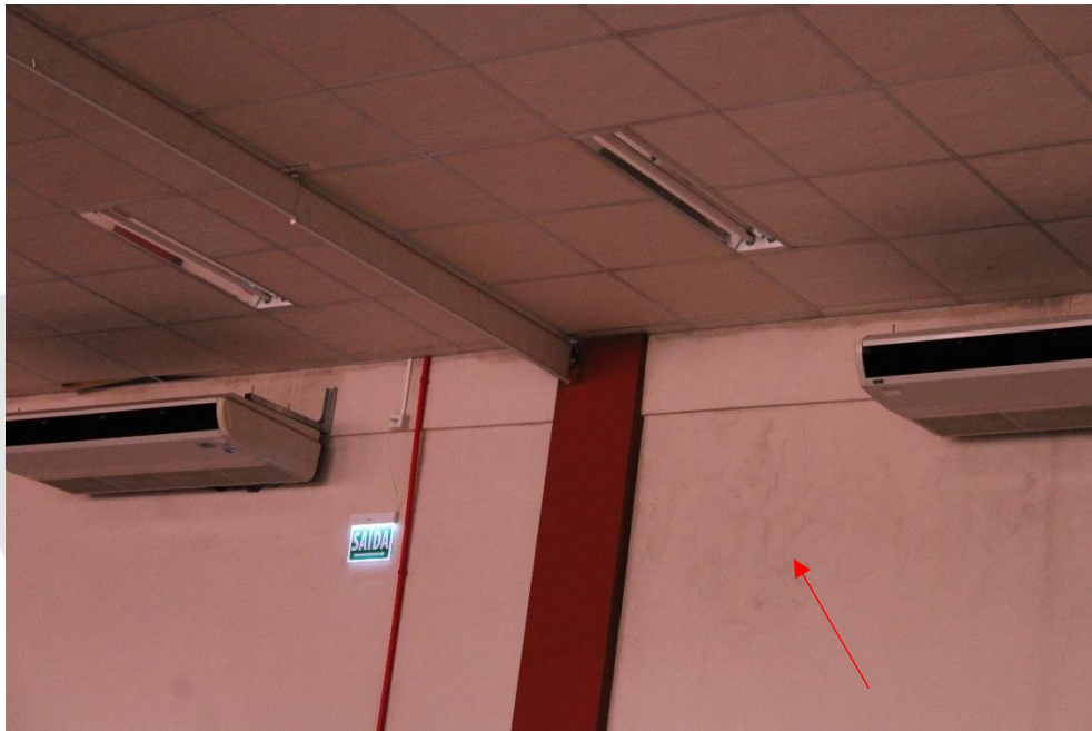
Foto 64- Sinais de infiltração nas paredes do auditório.
