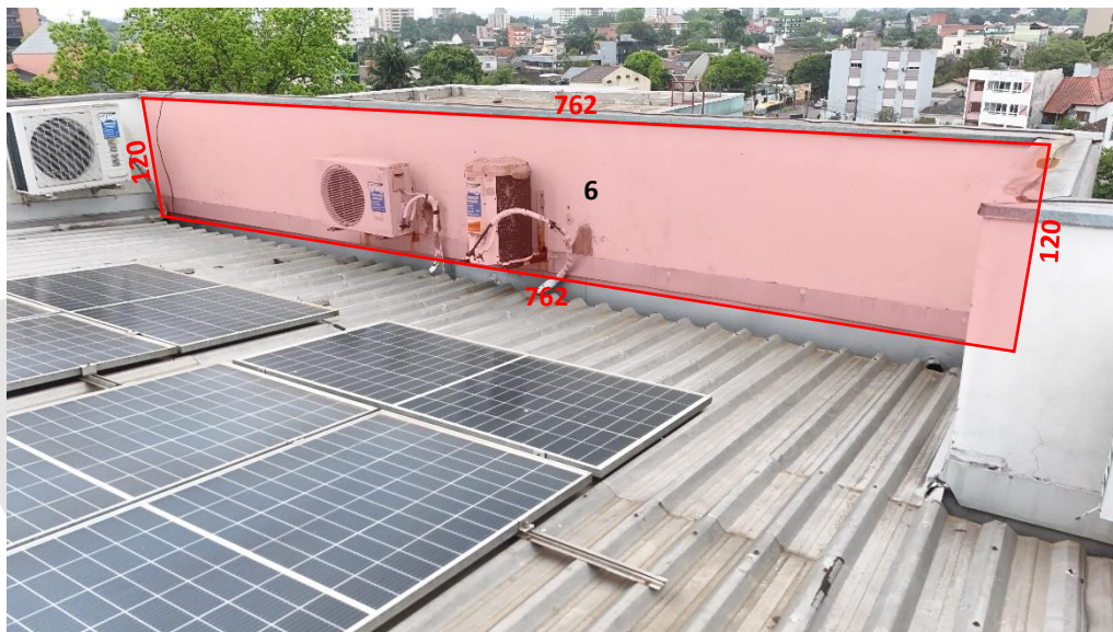
Foto 42 – Medidas da platibanda 6 em cm.
