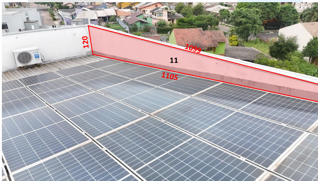
Foto 47 – Medidas da platibanda 11 em cm.
