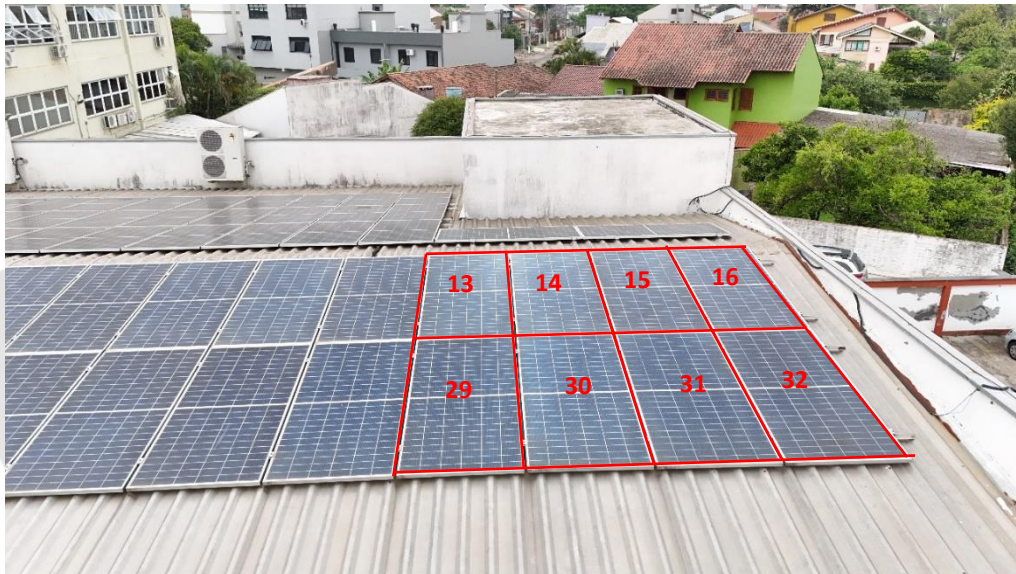
Foto 97 – Placas fotovoltaicas da cobertura 2.
