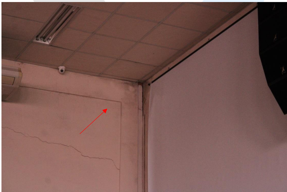
Foto 65- Sinais de infiltração nas paredes do auditório.
