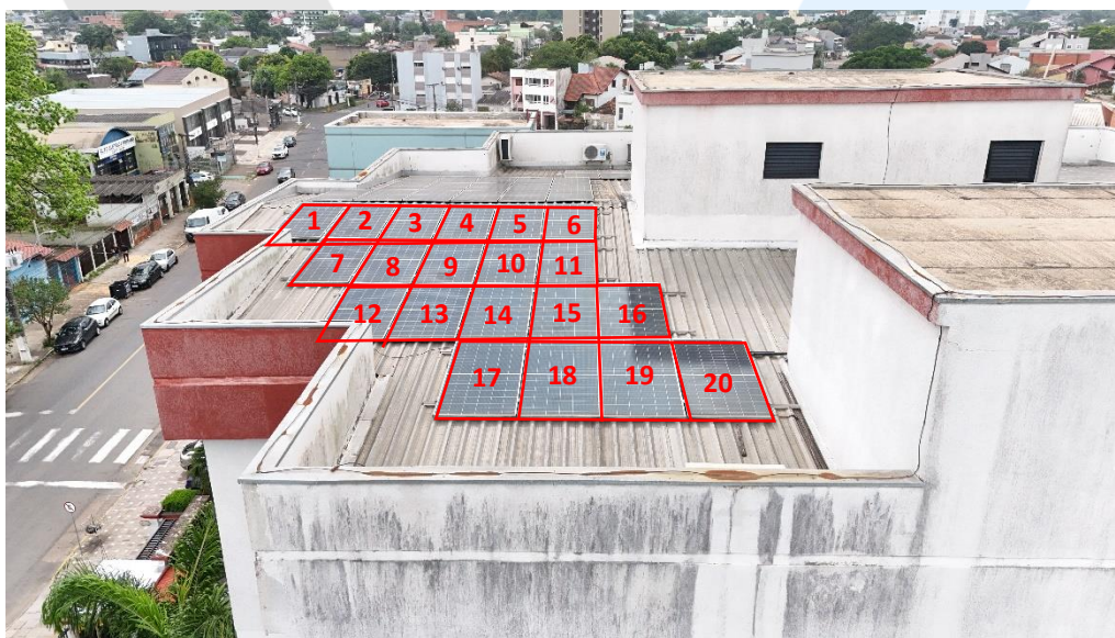
Foto 59 - Placas fotovoltaicas da cobertura 1.
