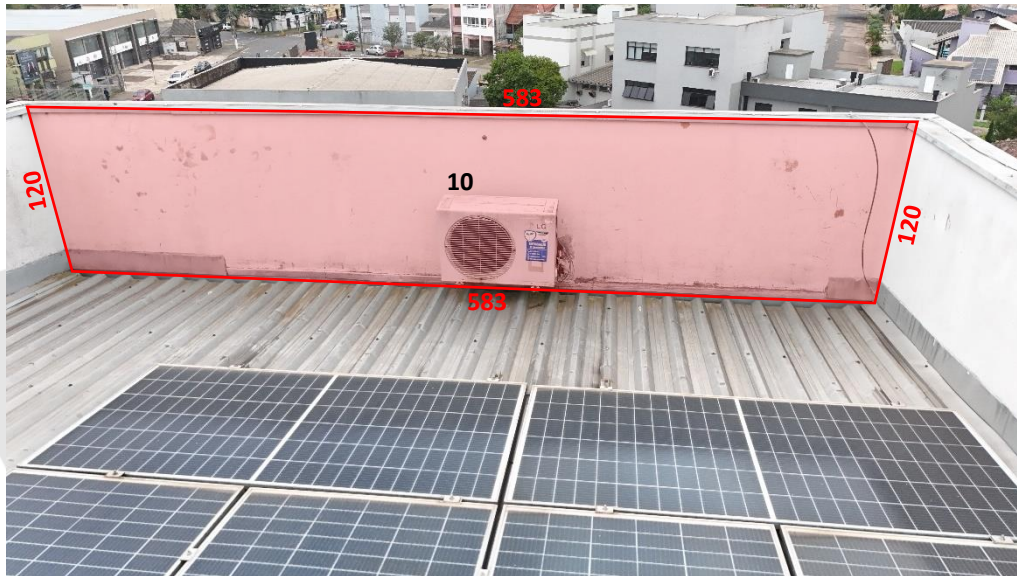
Foto 46 – Medidas da platibanda 10 em cm.
