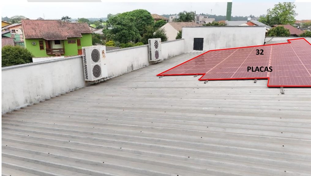
Foto 98 – Placas fotovoltaicas da cobertura 2.
