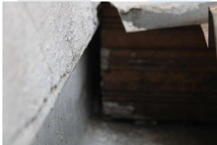
Foto 93- Presença de tijolos na calha.
