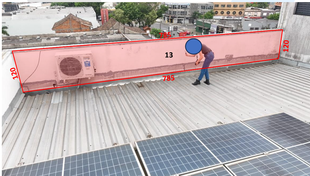
Foto 49 – Medidas da platibanda 13 em cm.
