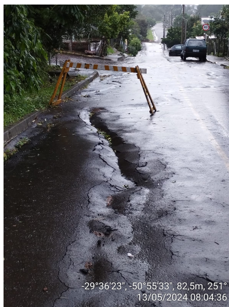
Foto 4: Afundamento no leito da rua, próxima à esquina com a Rua Pedro Schardong
