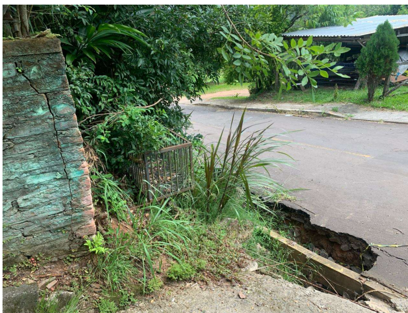
Foto 6: Fissura em muro, quebra de acesso de veículo e afundamento do solo junto ao meio-fio.
