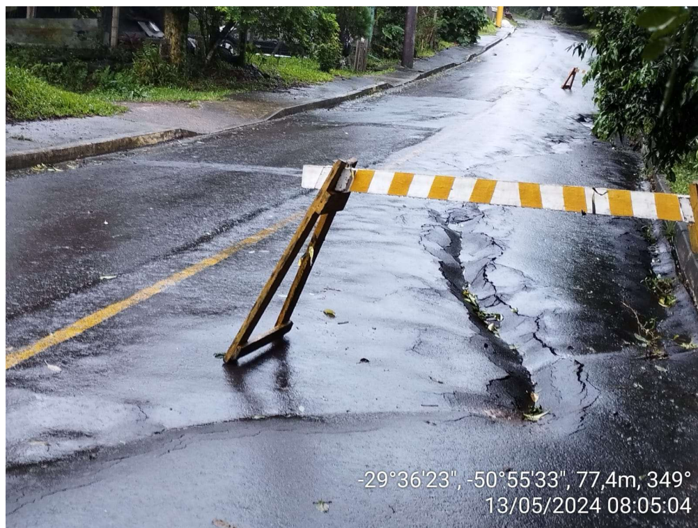
Foto 2: Leito afundado em apenas um lado do trecho pavimentado. Nota-se a fissura existente em toda a extensão do trecho no meio da pista, onde se percebe que está acontecendo um desnível para o lado direito da faixa de rolamento.
