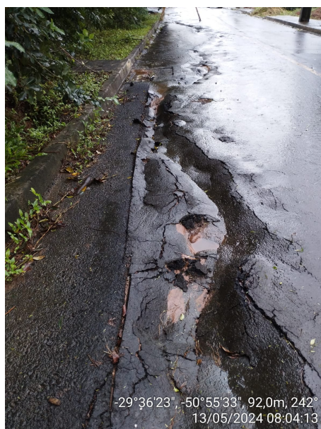
Foto 5: Afundamento e quebra da camadas asfáltica
