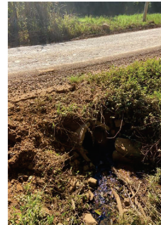
Imagem 4 – Dispositivos de drenagem
