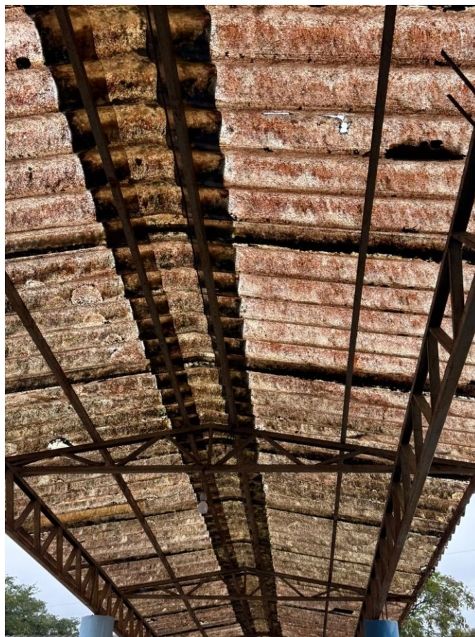
Imagem – oxidação das treliças existentes
