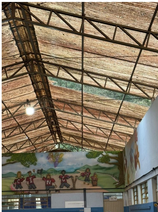
Imagem – oxidação das treliças existentes
