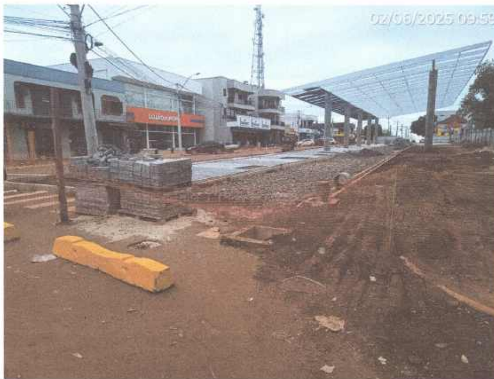
Figura 1: Vista geral da obra sentido Norte-Sul, onde-se nota-se entres outros a ausência dos tapumes, serviço de pavimentação inacabado, restos de materiais e entulho espalhados pela obra.
