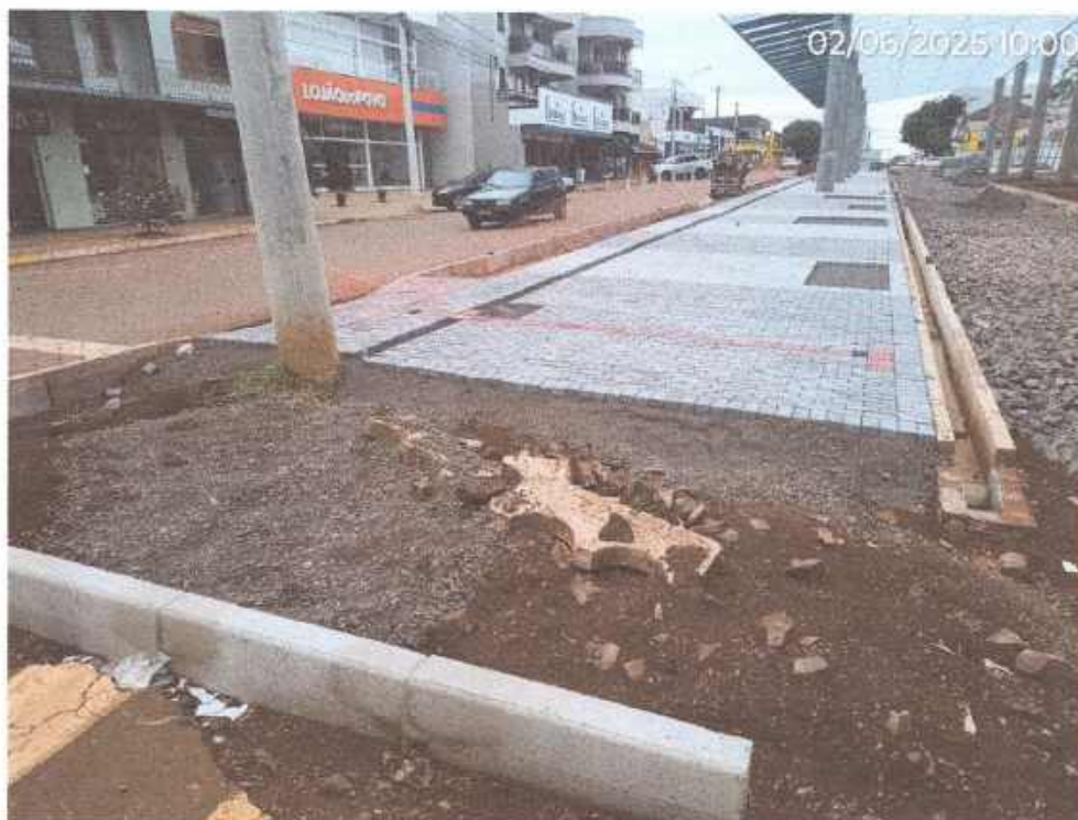
Figura 3: Vista geral da face Leste para Avenida do Comércio, pavimentação de Intertravado parcialmente executada, canaleta e caixas de drenagem sem grelhas e tampas, canteiros com restos de entulho.
