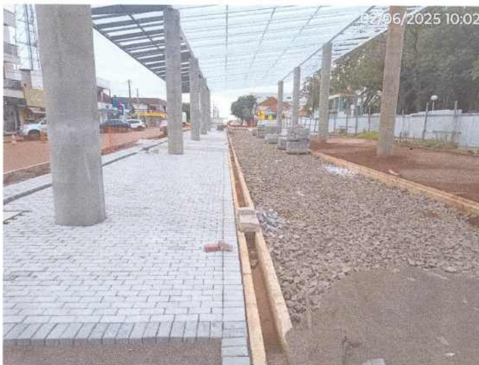
Figura 4: Vista geral do interior da obra, a esquerda/Leste pavimentação de Intertravado parcialmente executada, ausência de piso podotátil, rejunte e compactação, ao centro canaletas de drenagem, sendo necessário acabamento e instalação de grelha, e execução do piso drenante; a direita/Oeste, houve apenas a remoção do pavimento existente, necessário a execução da pavimentação; na parte superior tem-se a estrutura metálica da cobertura, parcialmente concluída, sendo necessário a conclusão da pintura de acabamento e pequenos ajustes no alinhamento de alguns perfis.
