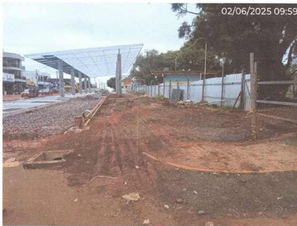
Figura 2: Vista geral da face Oeste da obra/frente, nota-se parte do tapume remanescente, ausência de pavimentação e meio-fio, canaleta e caixa de drenagem inacabadas, sem grelhas e tampas, sujeira e resíduos espalhados na obra.
