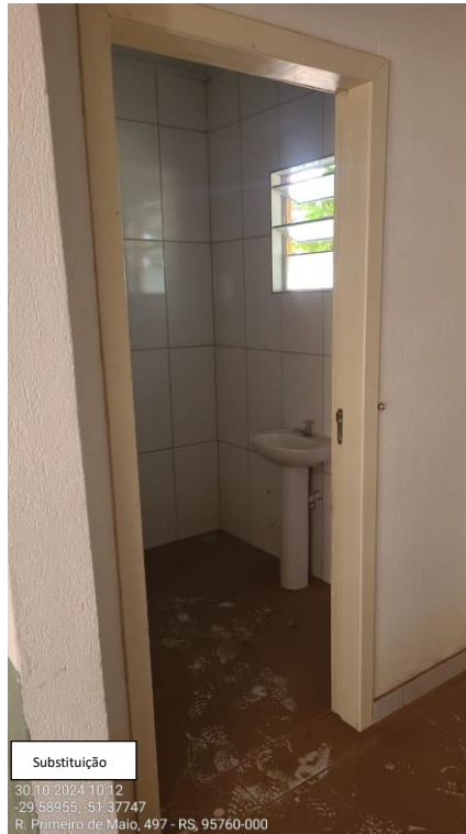
Imagem 62 – Porta interna a ser substituída por porta metálica.
