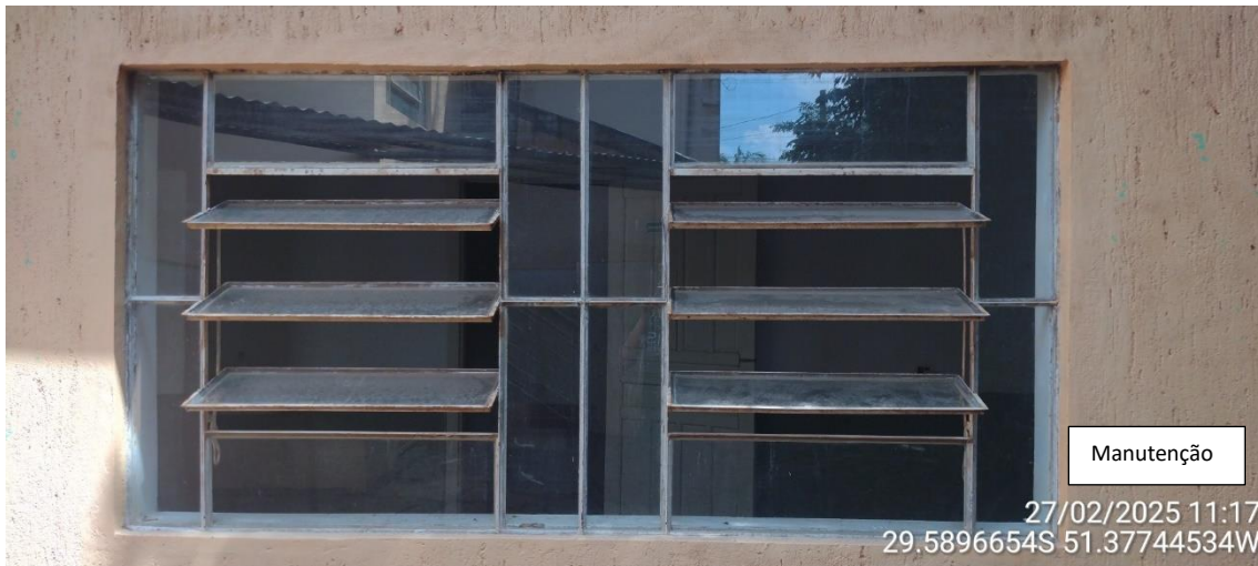
Imagem 41 – Esquadria metálica a receber manutenção e pintura.
