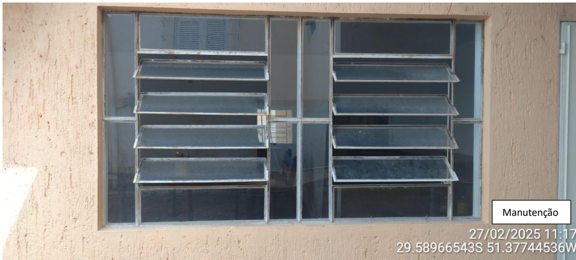
Imagem 42 – Esquadria metálica a receber manutenção e pintura.
