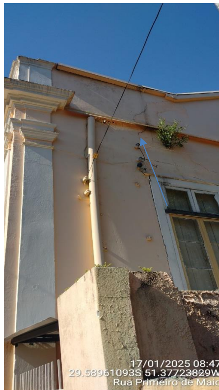
Imagem 07 – Fachada lateral com fissura vertical.
