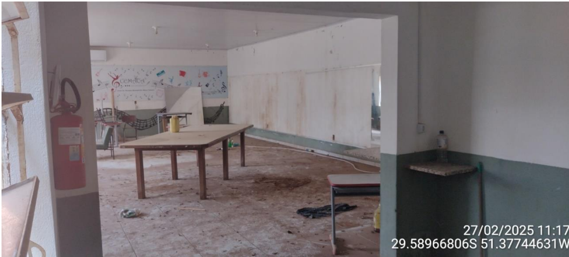
Imagem 67 – Paredes internas prédio fundos.
