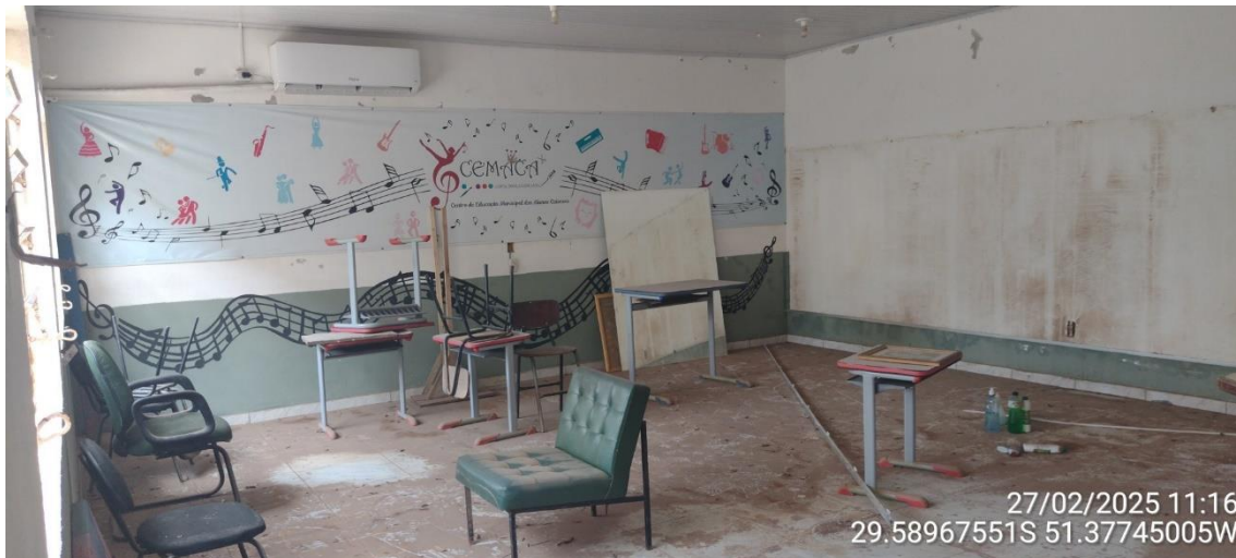
Imagem 66 – Paredes internas prédio fundos.
