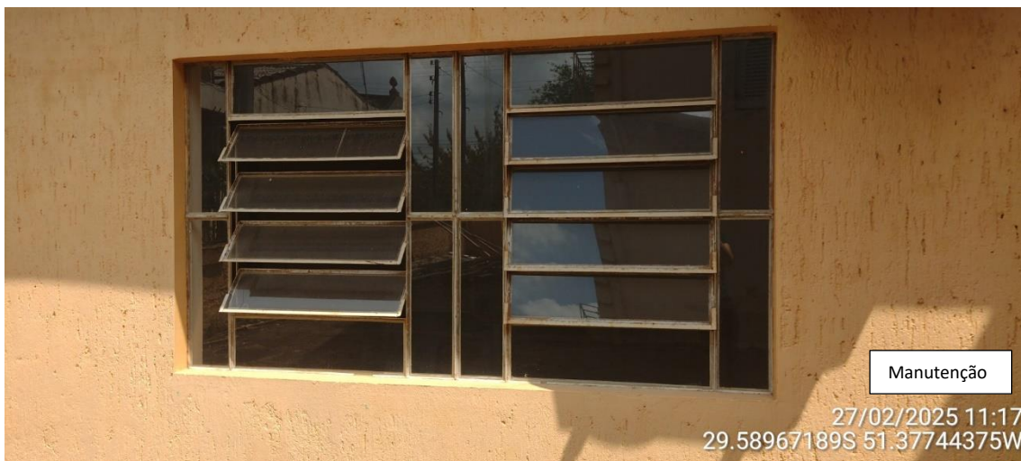
Imagem 43 – Esquadria metálica a receber manutenção e pintura.
