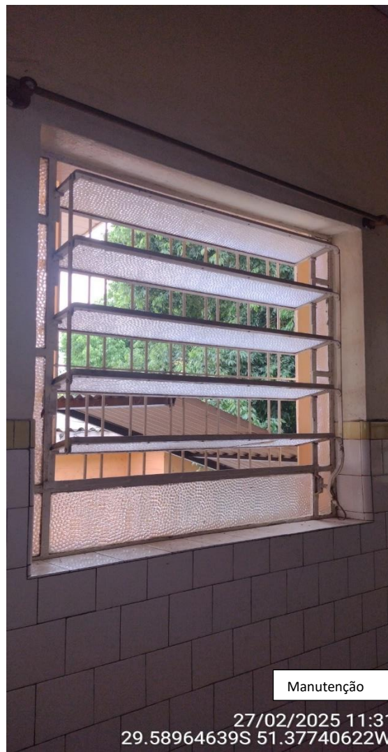
Imagem 25 – Esquadria metálica a receber manutenção e pintura.
