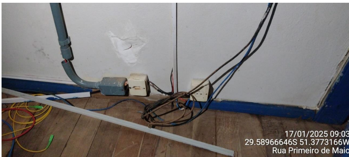
Imagem 22 – Instalações elétricas afetadas.
