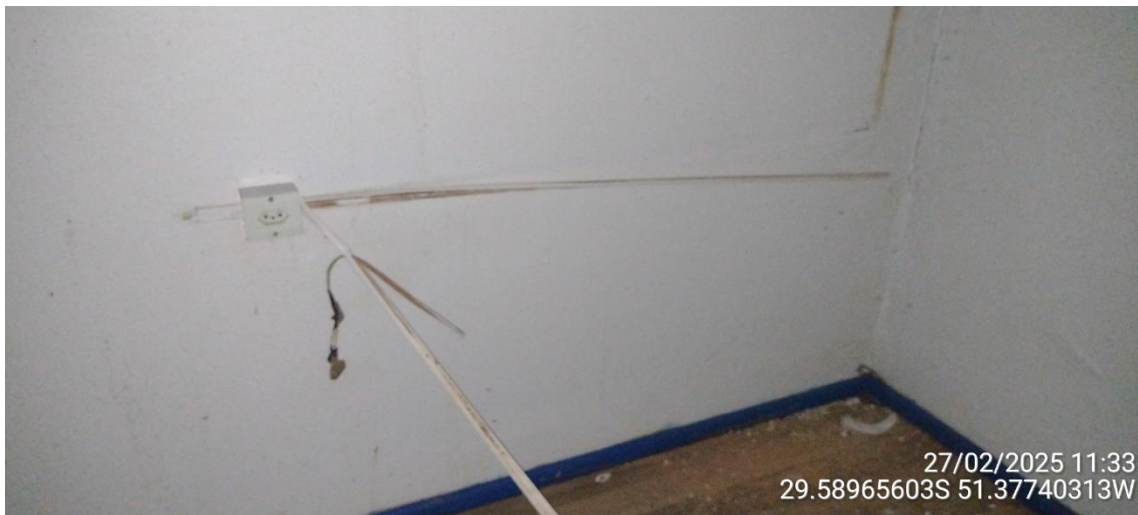
Imagem 23 – Instalações elétricas afetadas.
