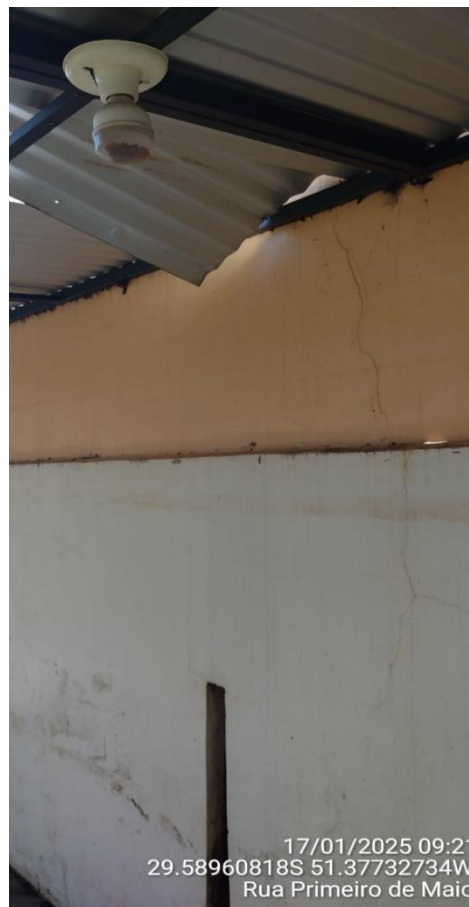
Imagem 24 – Instalações elétricas afetadas.
