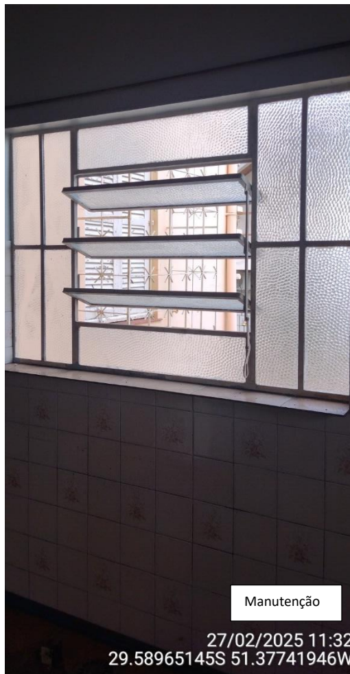
Imagem 37 – Esquadria metálica a receber manutenção e pintura.
