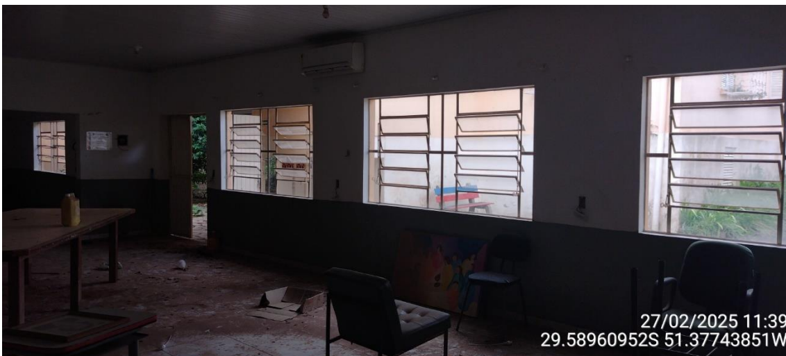
Imagem 68 – Paredes internas prédio fundos.
