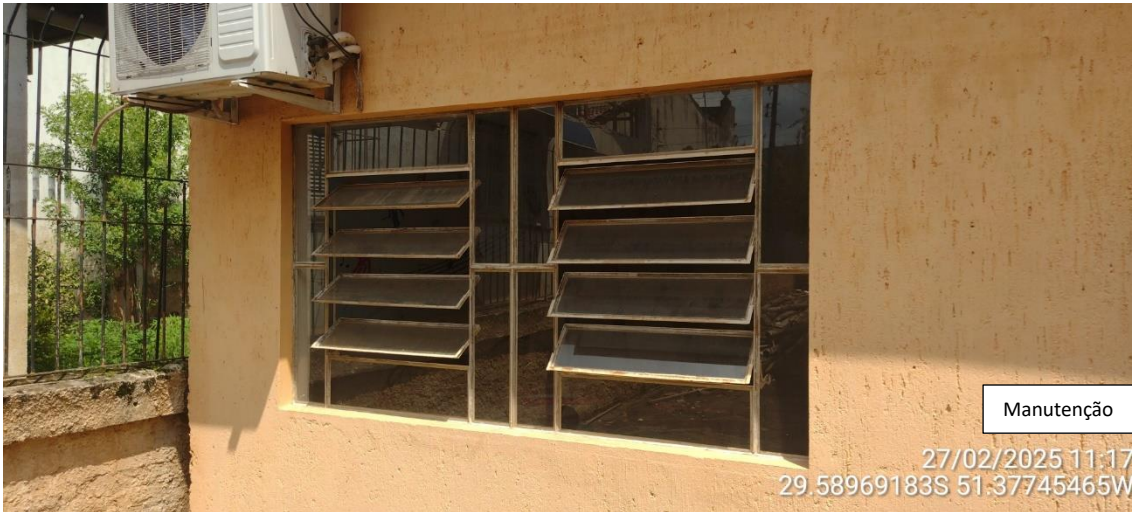
Imagem 44 – Esquadria metálica a receber manutenção e pintura.
