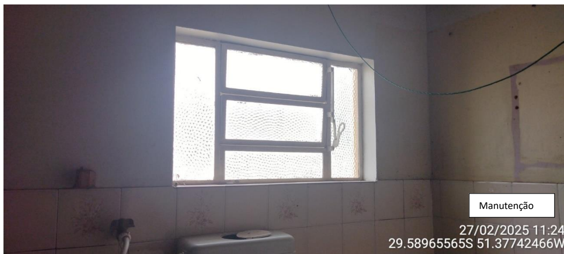
Imagem 38 – Esquadria metálica a receber manutenção e pintura.
