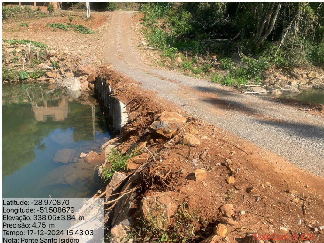
Imagem 2: a passagem molhada com tubos se trata de uma solução temporária, visto que facilmente fica submersa e pode ser destruída.
