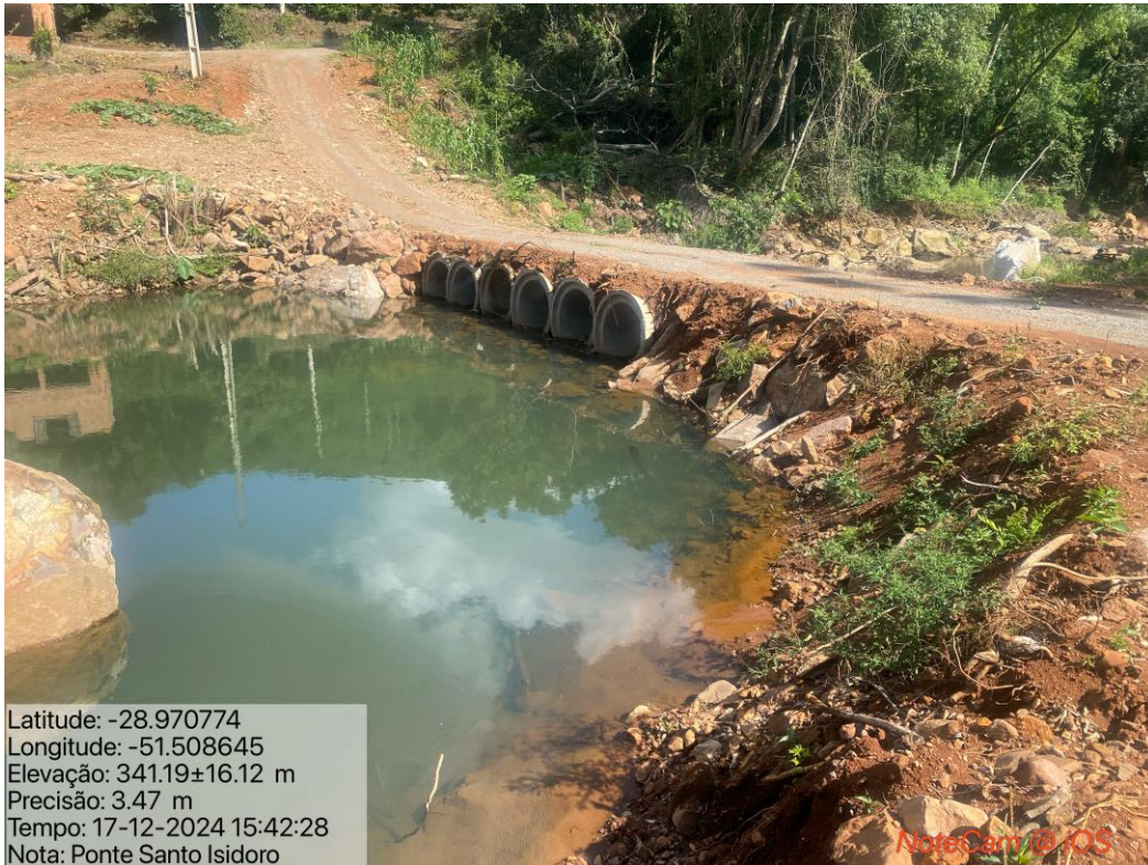
Imagem 1: foi realizada no local uma passagem molhada com tubos, com o objetivo de restabelecer o acesso dos moradores aos serviços essenciais, bem como para viabilizar o escoamento agropecuário e o recebimento de insumos aos moradores.
