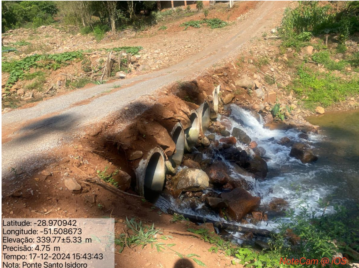
Imagem 3: outra vista da passagem molhada que foi executada no local da ponte para permitir o acesso dos moradores.
