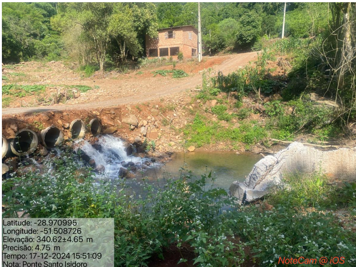
Imagem 4: a direita pode-se observar um pedaço da estrutura da ponte que foi destruída durante o evento climático.
