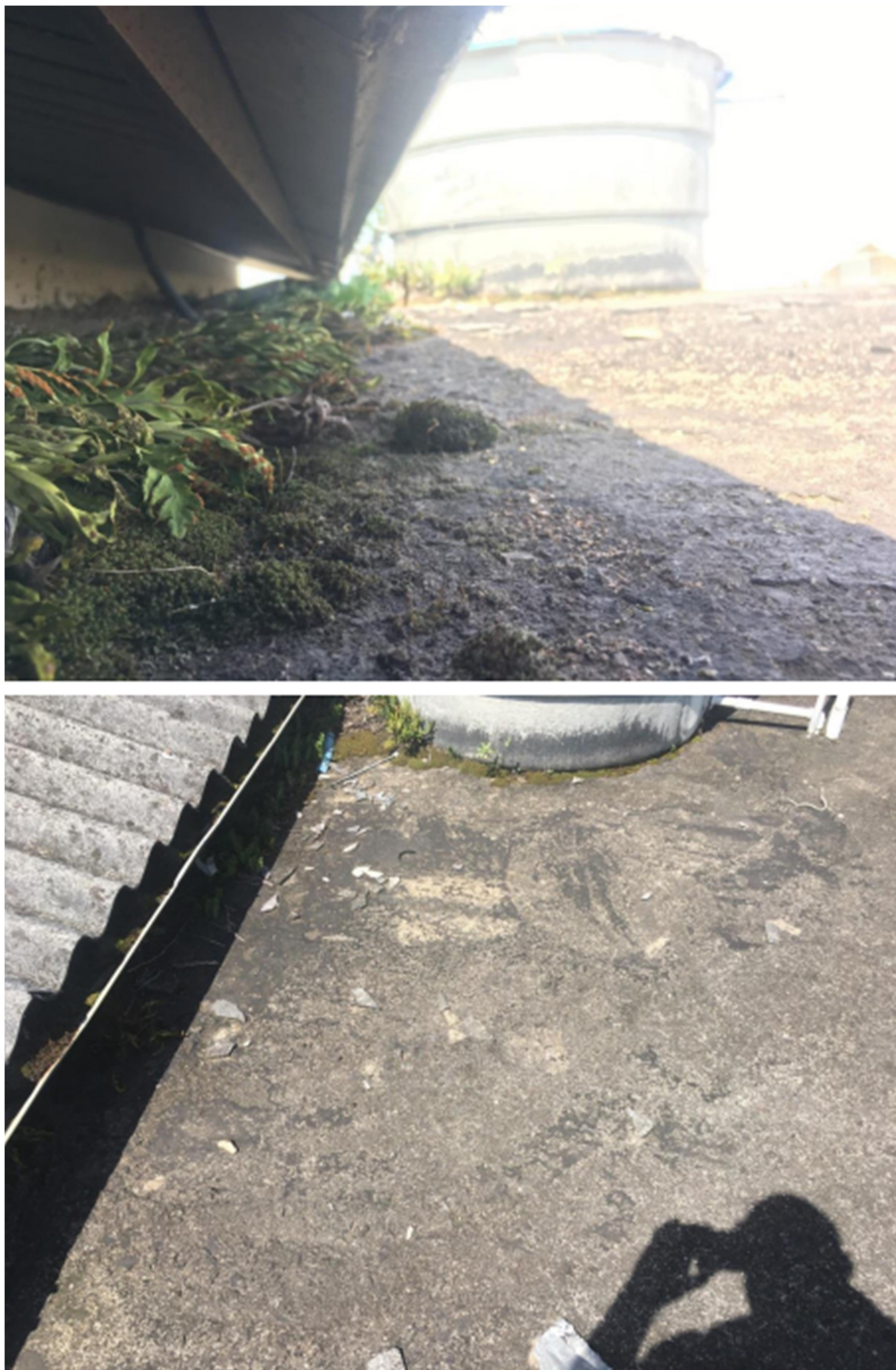
Figura 8 - Imagens de problemas na cobertura dos banheiros do 2º pavimento.
