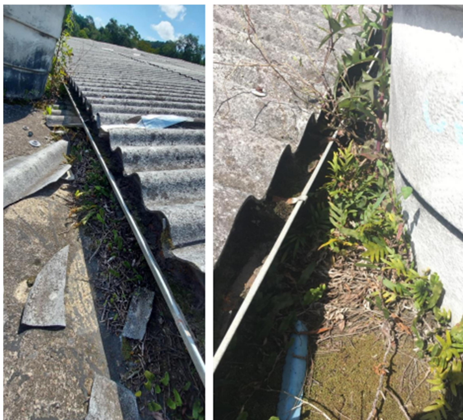
Figura 7 - Imagens de problemas na cobertura dos banheiros do 2º pavimento.
