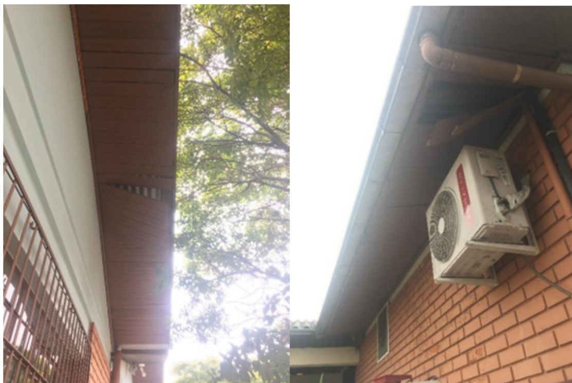
Figura 6 – Deterioração de beirais.
