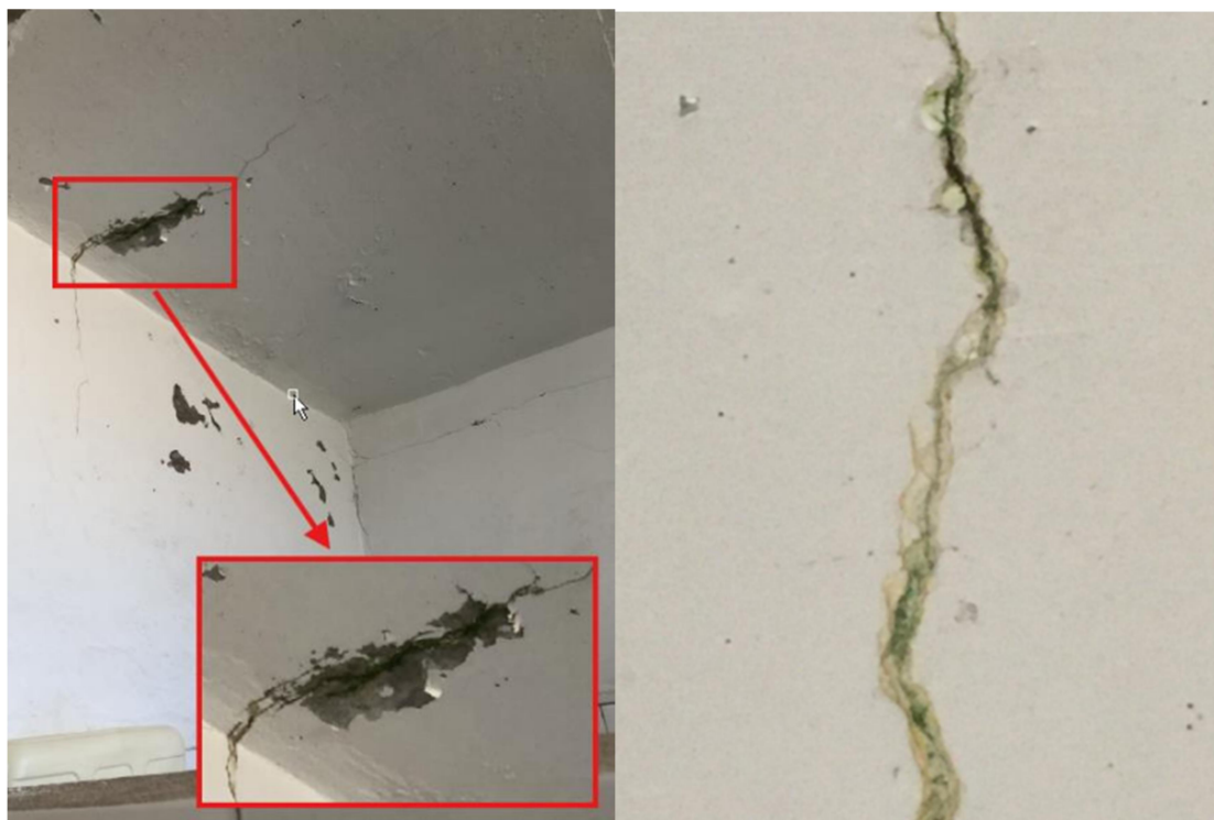
Figura 1 - Rachadura com ferrugem aparente e fissuras com infiltrações nos tetos dos banheiros do 2º pavimento do prédio 2.
