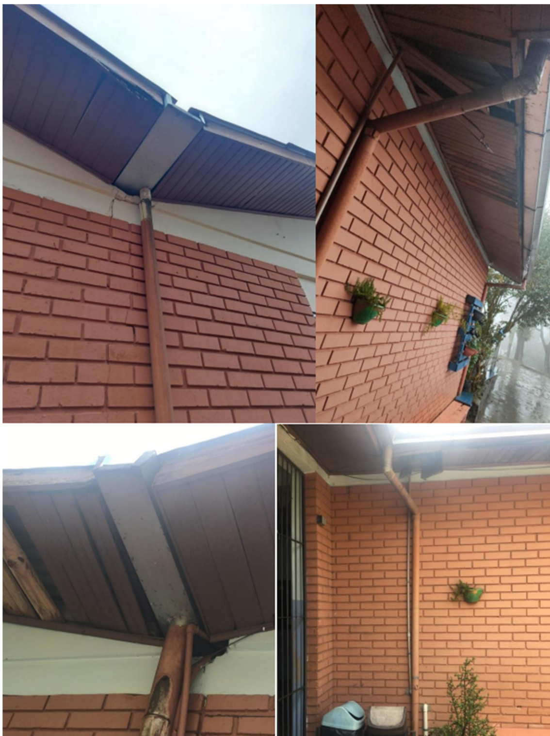
Figura 5 – Imagens de partes dos beirais deteriorados.
