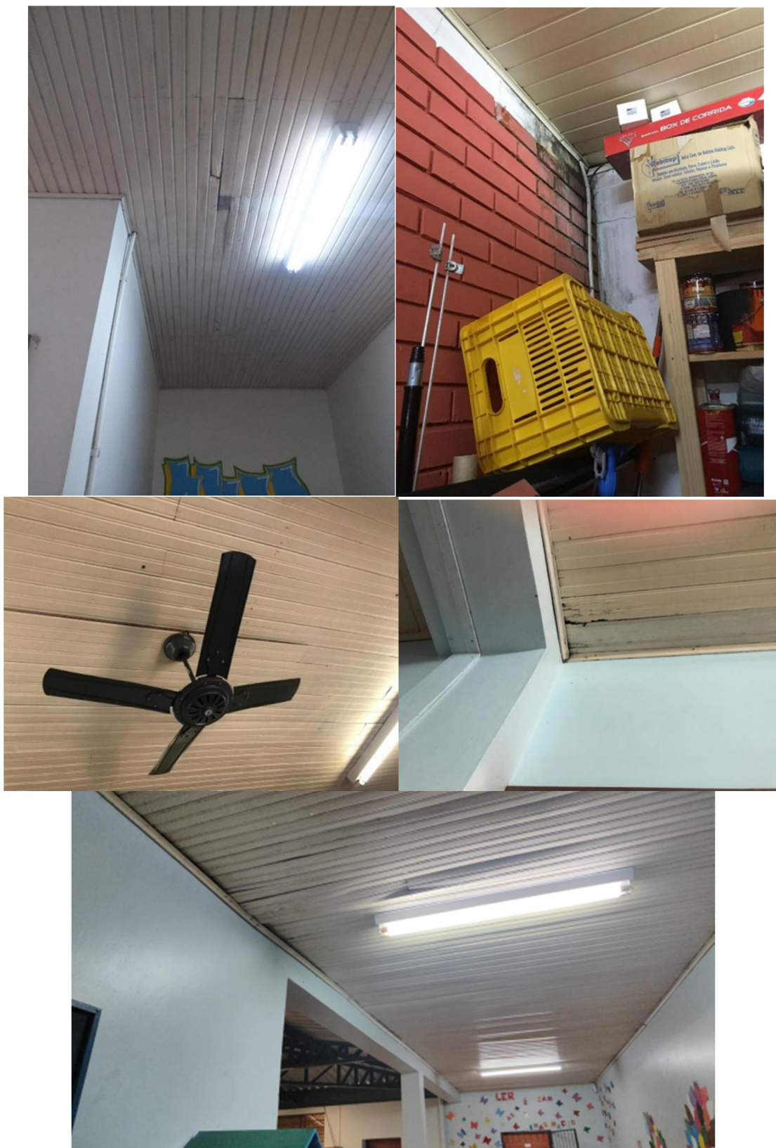
Figura 4 - Forros nos dois prédios avariados devido a infiltrações das coberturas e ao tempo de existência.
