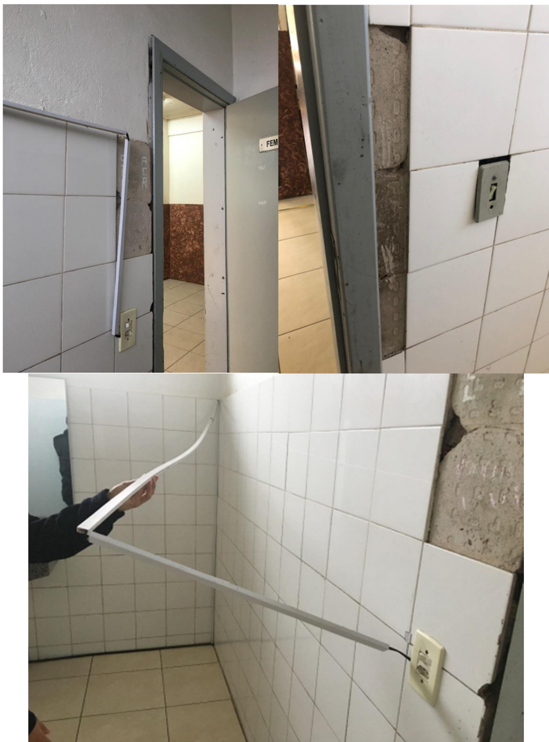
Figura 3 - Problemas nos banheiros do prédio 2.
