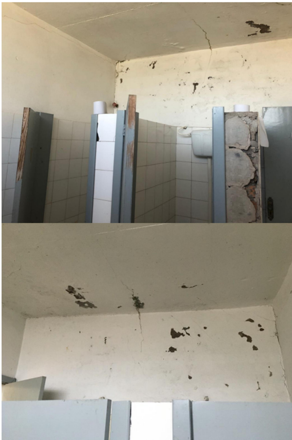
Figura 2 - Problemas nos banheiros do prédio 2.
