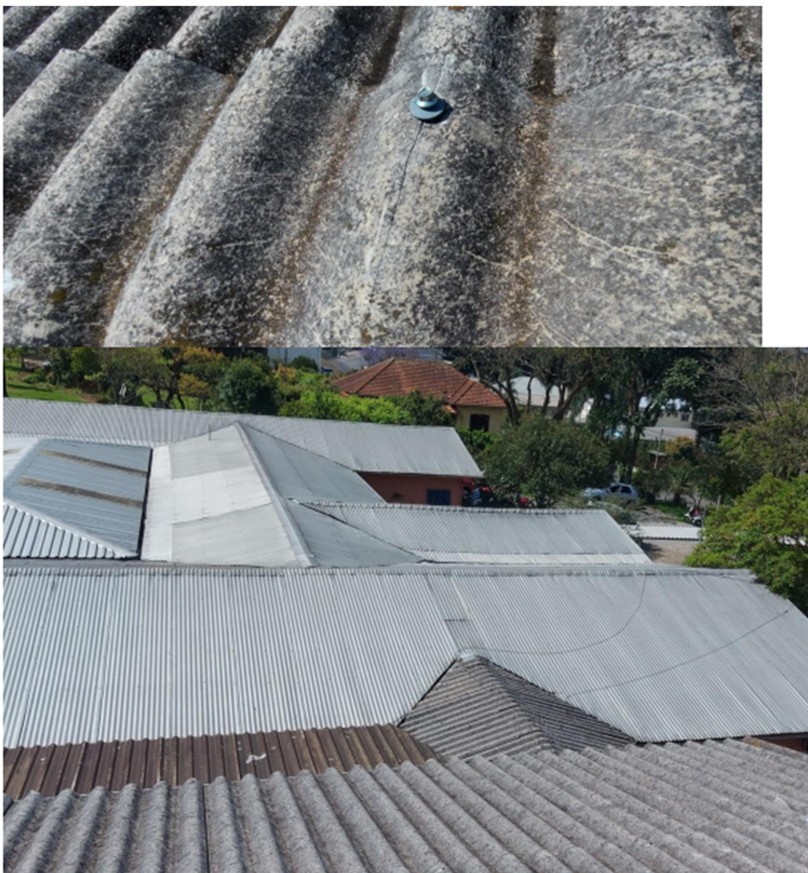
Figura 9 – Imagens das coberturas, que apresentam diversos pontos com infiltrações. Há pontos amassados, entortados, cumeeiras e junções entre panos problemáticos, locais com emendas.
