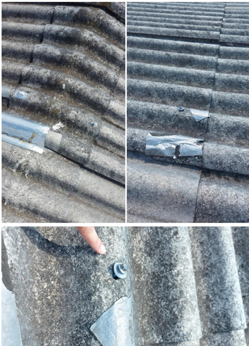
Figura 10 – Imagens de problemas nas coberturas.
