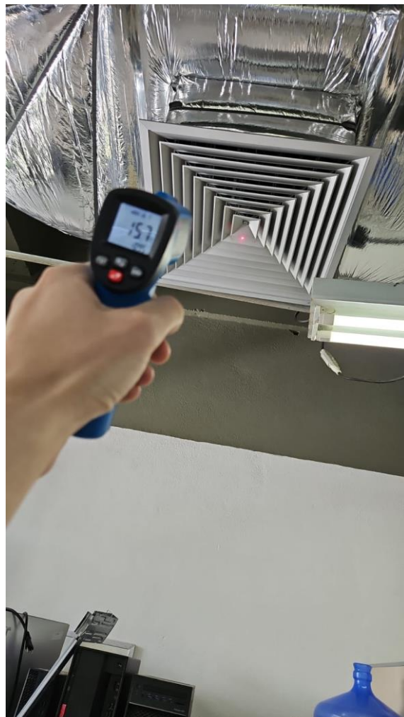
Temperatura Insuflamento Unidade Climatizadora Bult-In “fancolete” Sala 389
