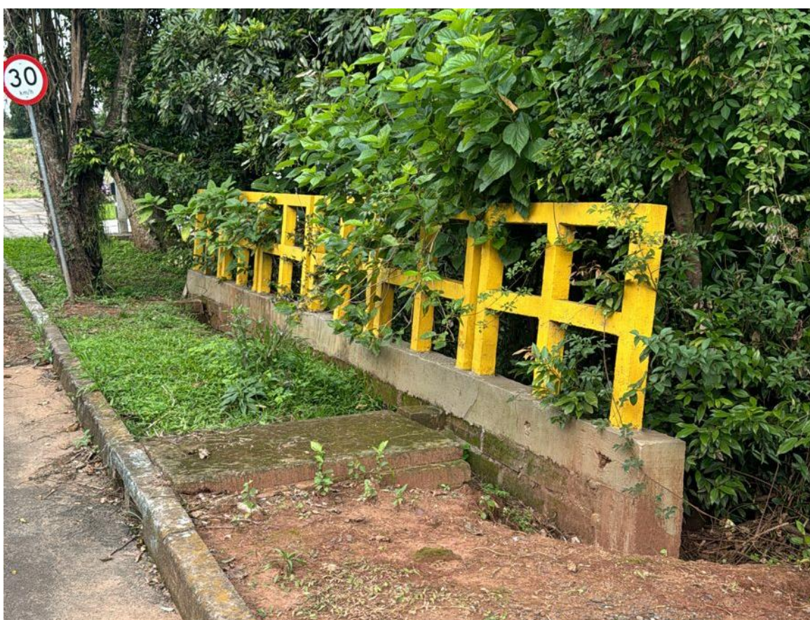
Figura 4: Guarda – corpo a ser recuperado
