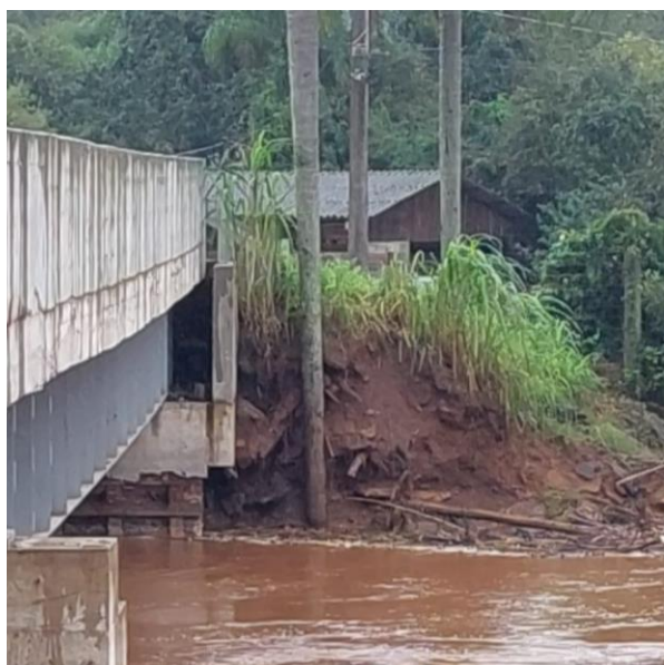
Figura 3: Assoreamento no pilar da ponte
