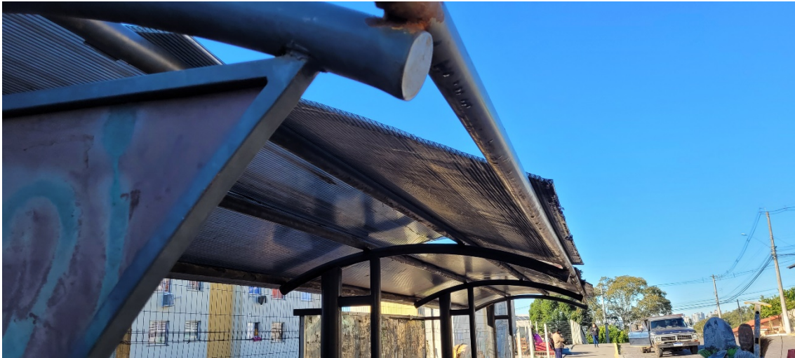
Telhas de polycarbonato danificadas. Fixação das terças tubulares da cobertura com corrosão e oxidação.
