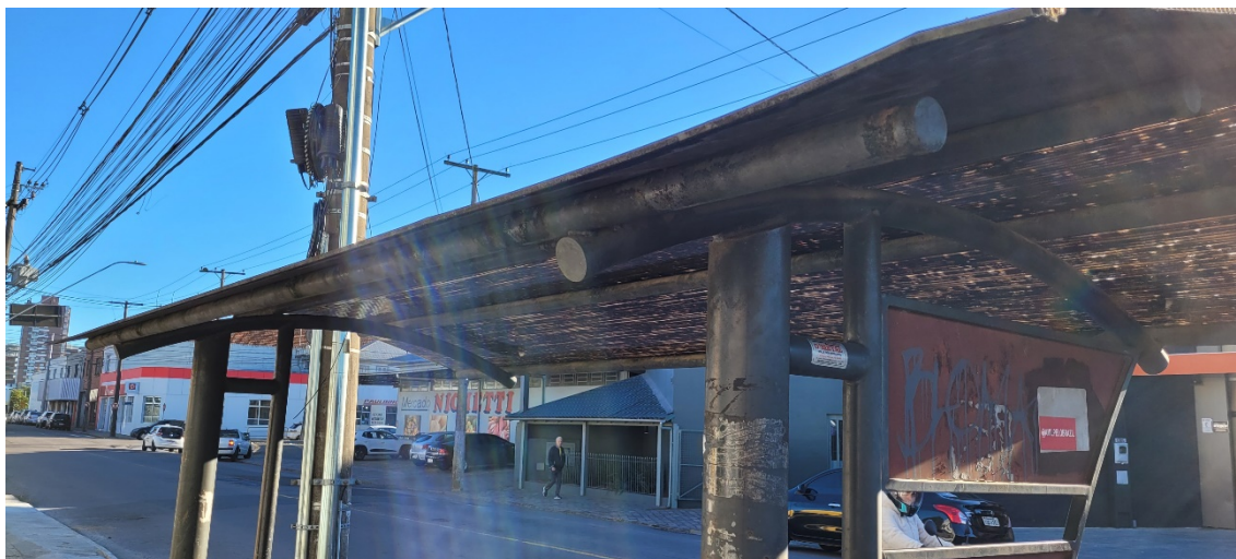
Cobertura de policarbonato totalmente degradada pelo tempo.
