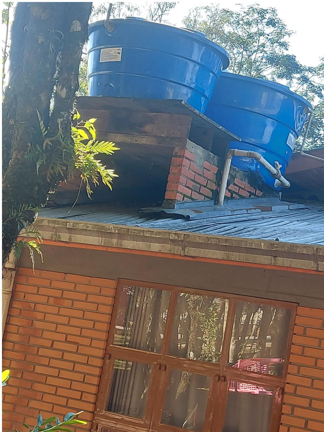
Figura 8 – Outro ângulo das condições da cobertura sobre região do depósito e enfermaria. Percebe-se as ondulações anormais e problemas de vedações devido ao estado de conservação precário.
