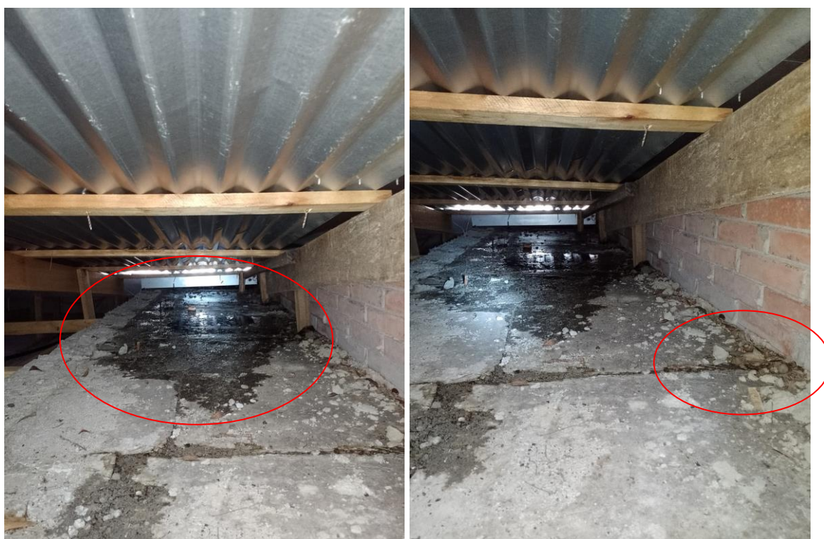
Figura 4 - Trecho de laje acima do forro do refeitório com água, que esco (da laje externa à direita) até a viga (à esquerda) e pinga para o interior do refeitório.
