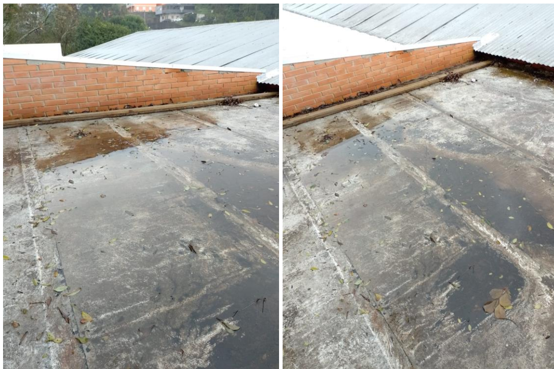
Figura 3 - Laje após chuva. Nota-se acúmulo de água sobre a superfície, não havendo inclinação adequada para escoar a água para fora, ocorrendo escoamento e infiltrações para áreas adjacentes, principalmente para o refeitório.
