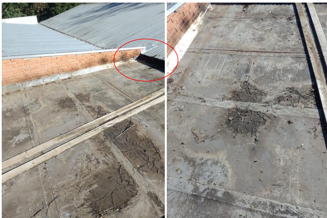
Figura 2 - Laje de cobertura da cozinha. Deterioração da impermeabilização e ausência de calha do telhado ao lado, que assim direciona a água para a laje.
