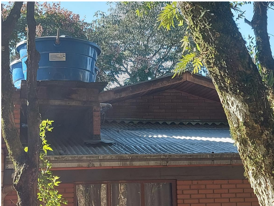
Figura 7 – Área de telhado sobre depósito e enfermaria avariada e com rebaixamentos nas telhas, indicando possibilidade de madeiramento estar deteriorado também.
