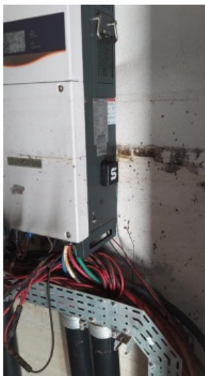
Foto 2: Marca da água na parede e no inversor.
