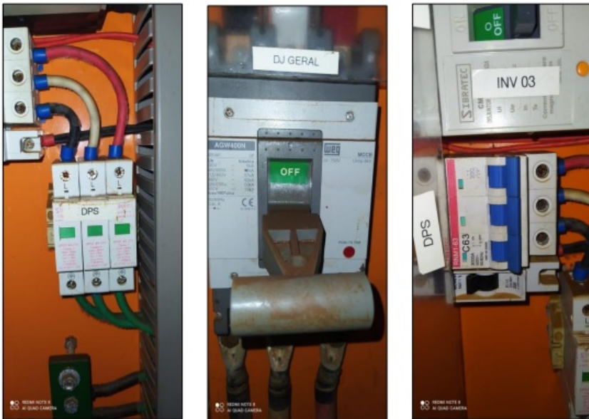
Foto 7: DPS e disjuntores
