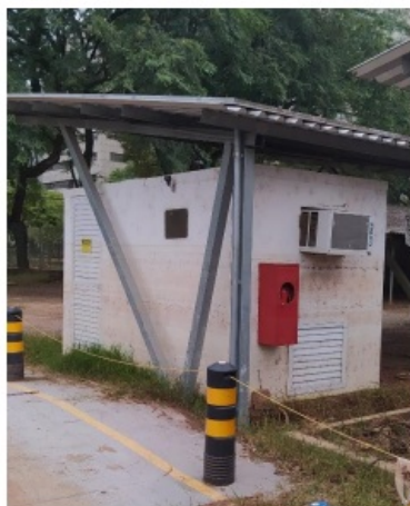
Foto 1: Cabine da usina fotovoltaica com a marca da água
