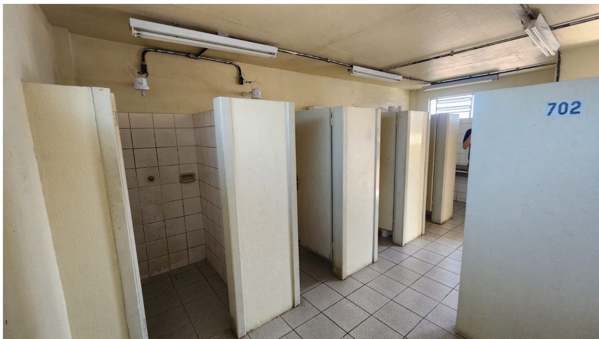
Figura 4: Cabines de chuveiros dos banheiros junto aos boxes.
