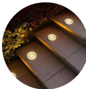
Fig. 04 – Exemplo de luminária sinalizadora de solo
