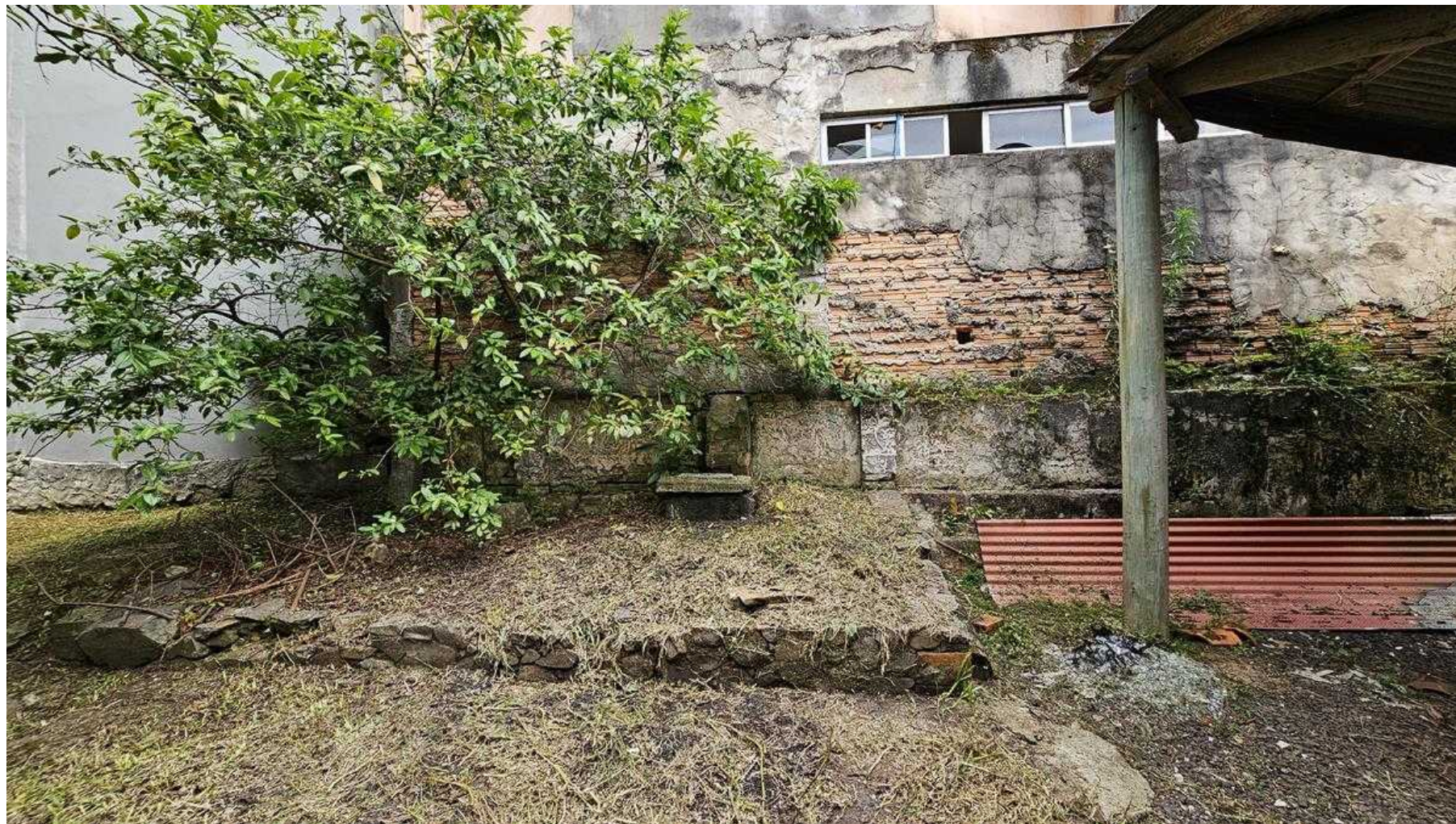
Imagem 39: Muro de Divisa Sudeste (saturado)
