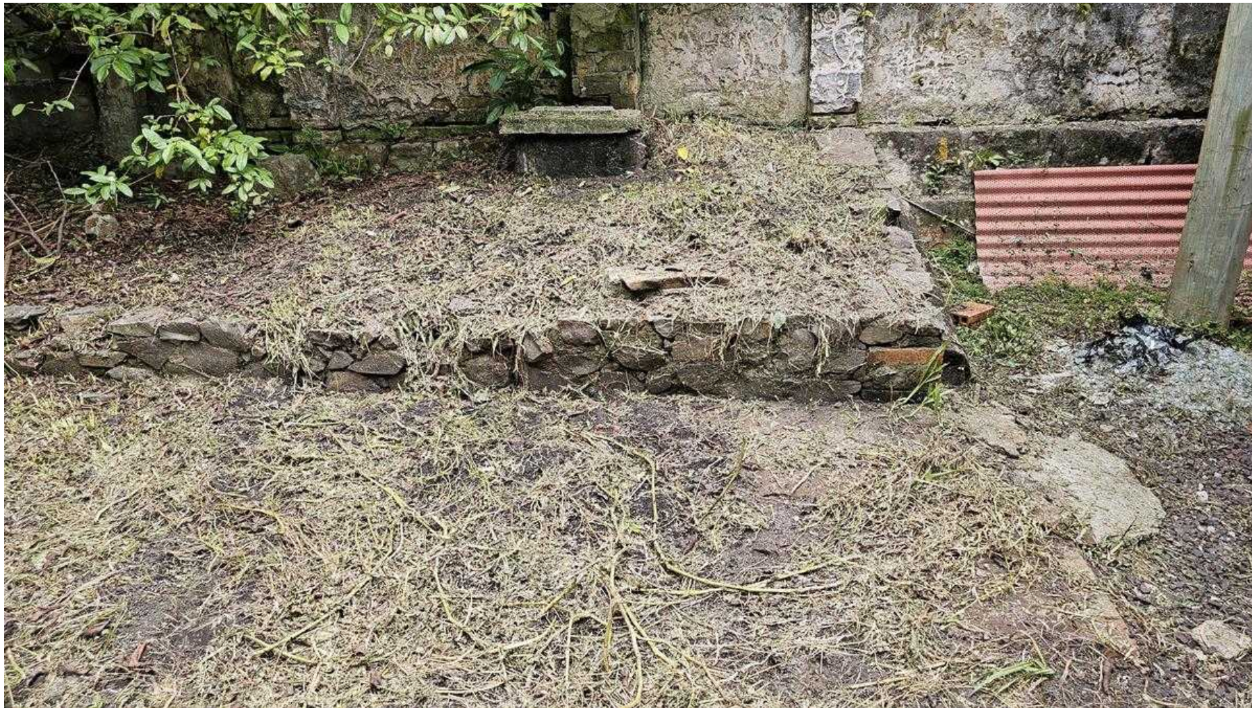
Imagem 40: Solo Saturado (caixa esgoto)
