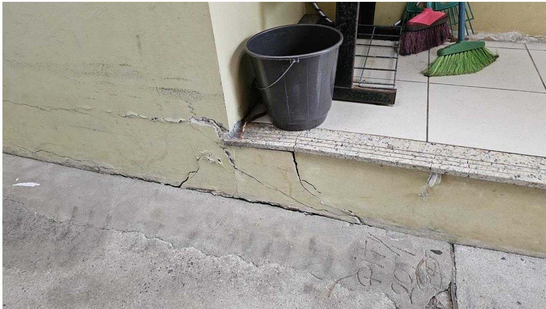
Imagem 45: Rachadura (base da edificação)
