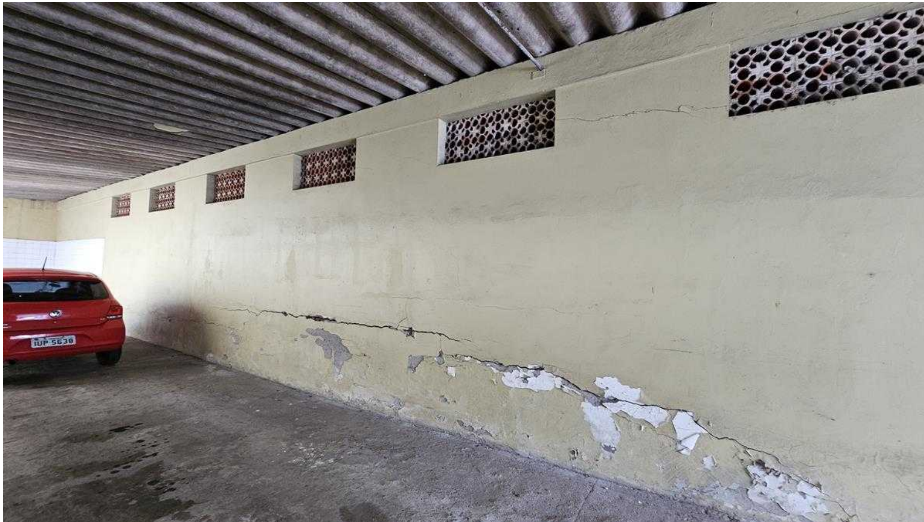
Imagem 31: Rachadura Muro (divisa sudoeste)
