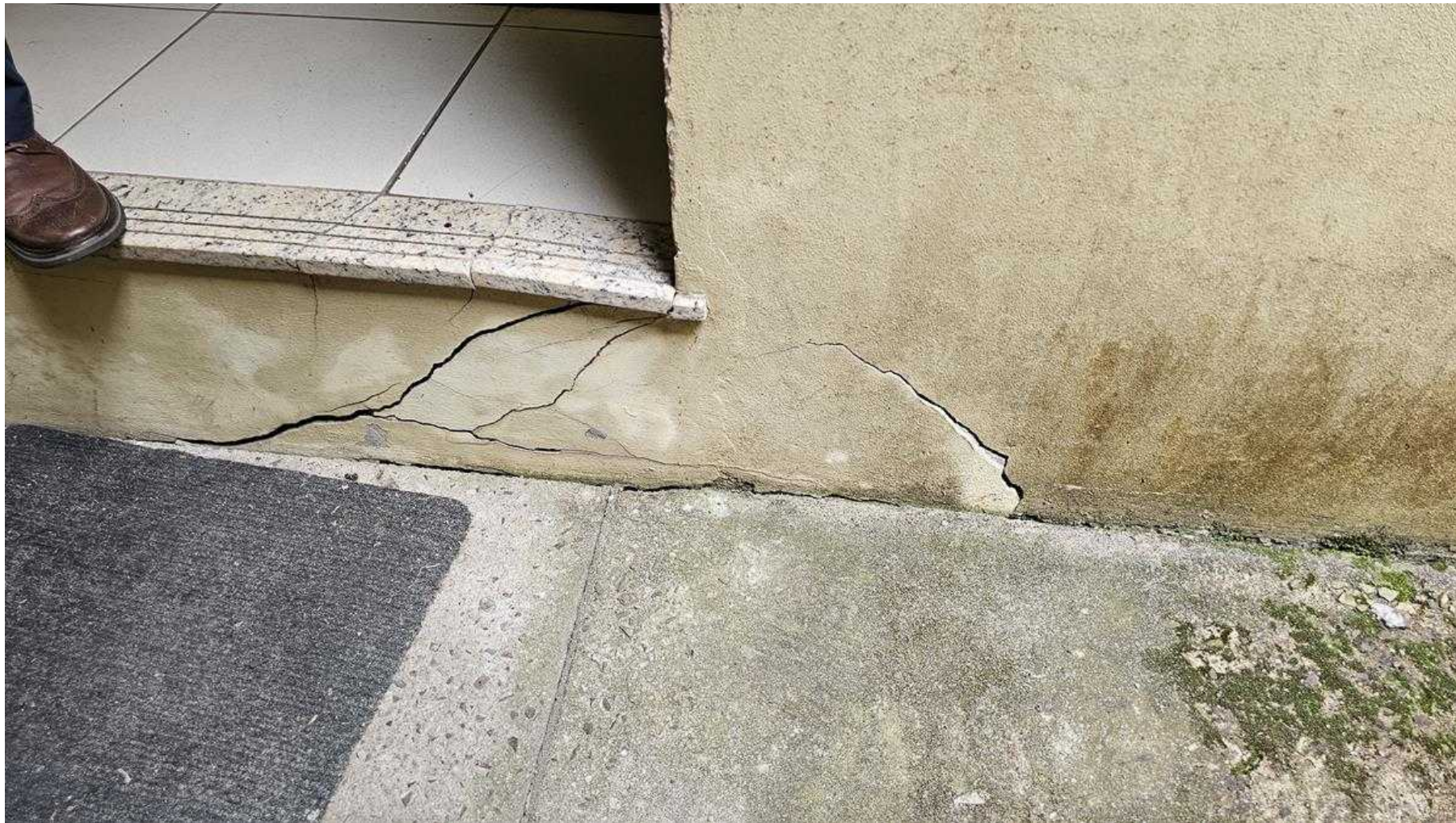
Imagem 46: Rachadura (base da edificação)
