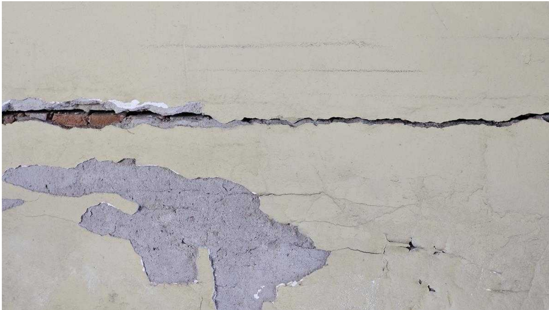
Imagem 32: Rachadura Muro (divisa sudoeste)
