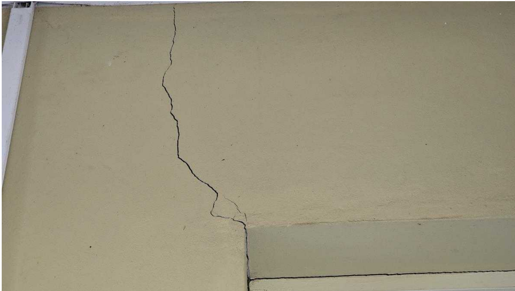
Imagem 48: Rachadura Acesso Fundos
