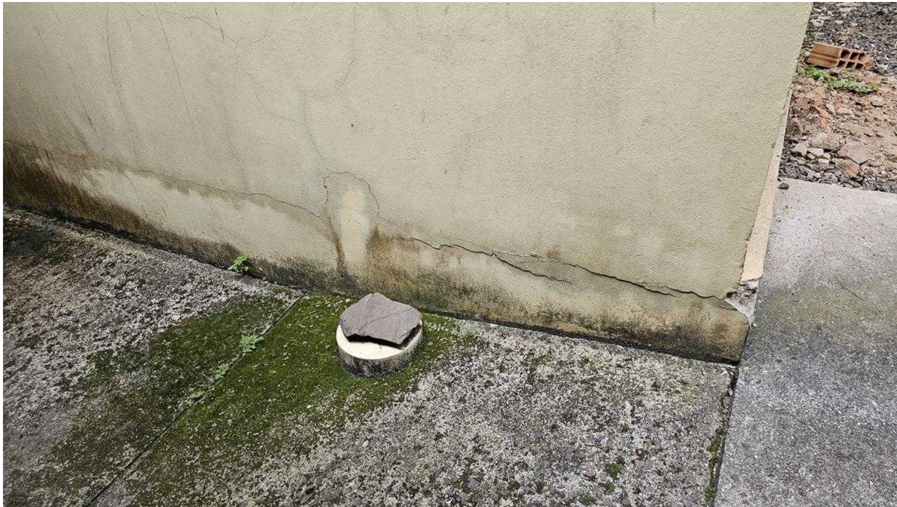
Imagem 44: Rachadura (base da edificação)
