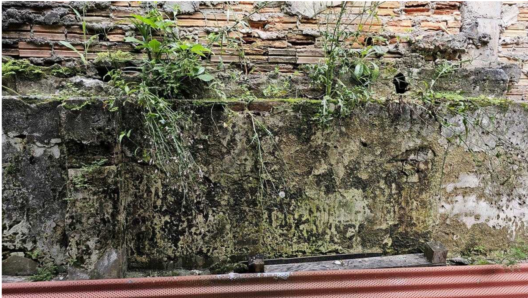
Imagem 38: Muro de Divisa Sudeste (saturado)
