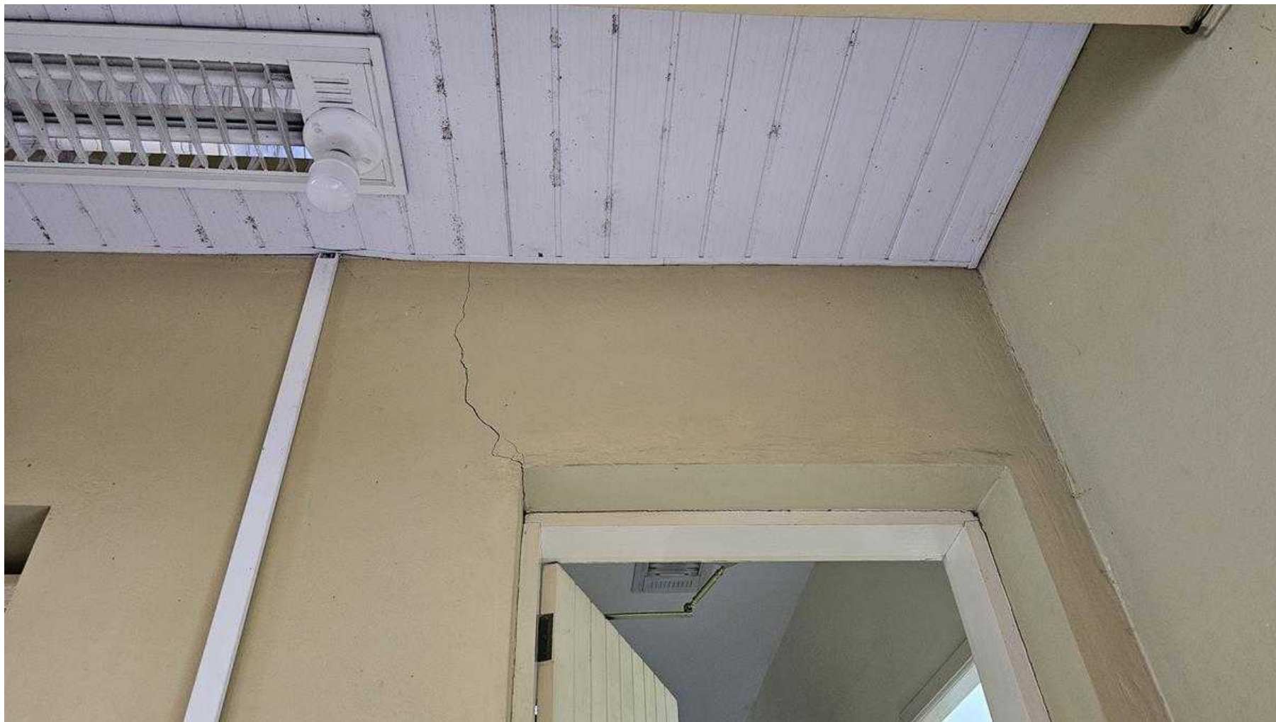
Imagem 47: Rachadura Acesso Fundos
