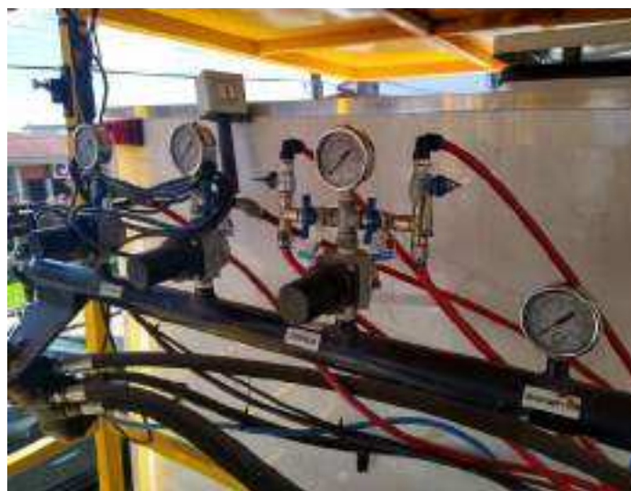
Sistema de distribuição do ar comprimido
