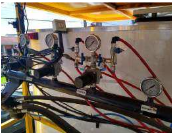
Reguladores de pressão dos tanques
