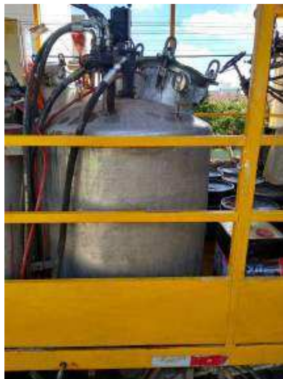
Vista traseira do tanque de tinta
