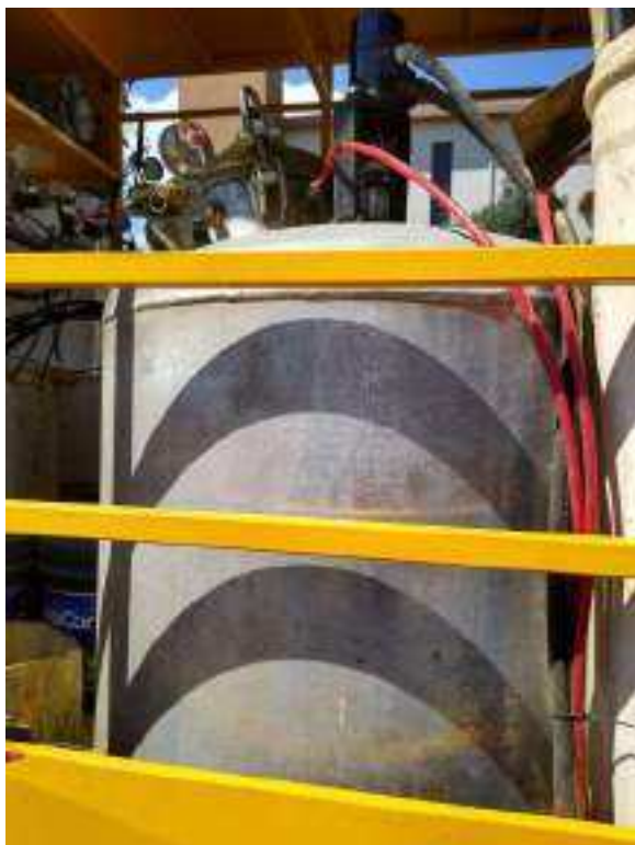
Vista traseira do tanque de pressão
