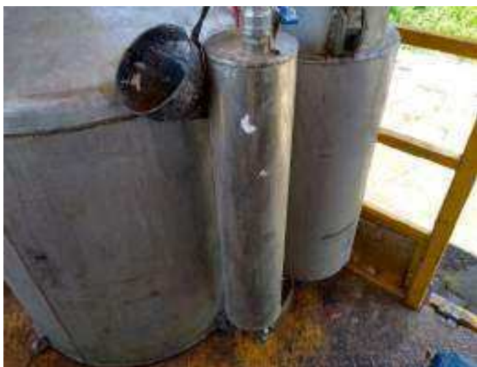
Tanque de solvente (central)
