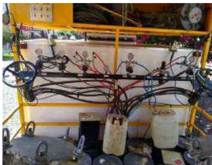
Sistema de distribuição de ar comprimido
