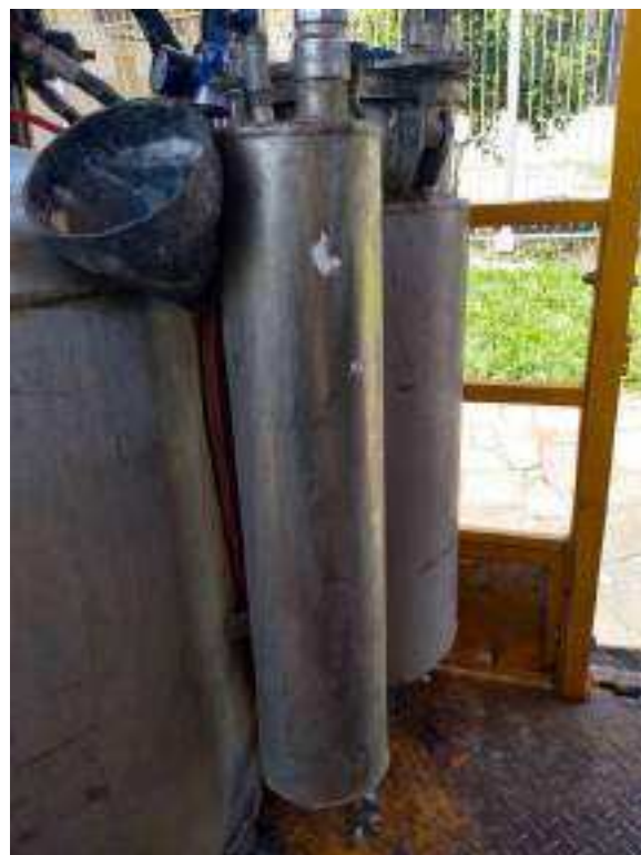
Vista frontal do tanque de pressão
