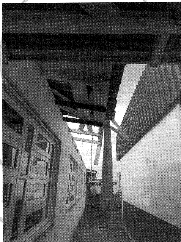
Figura 3: Alvenaria e beiral avariados
