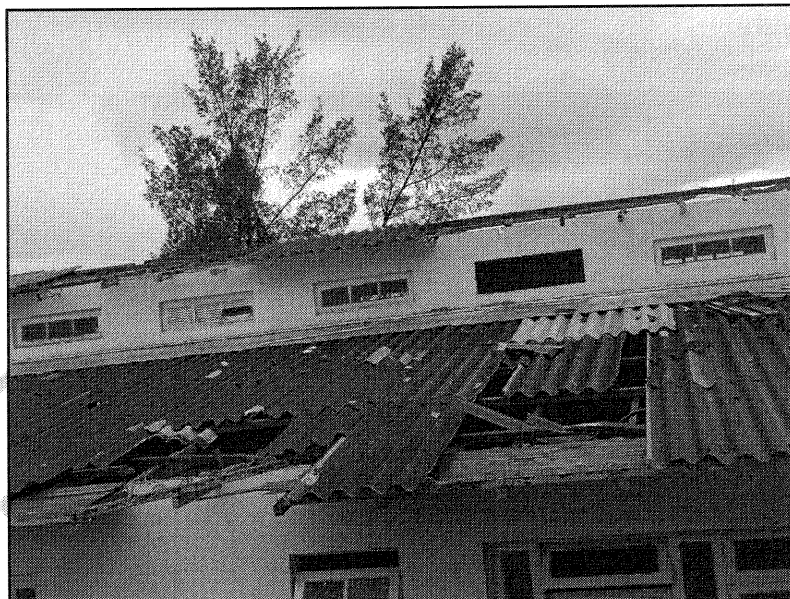
Figura 2: Cobertura com telhas arrancadas e quebradas
