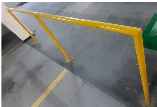
Imagem de um dos guarda-corpos existentes
